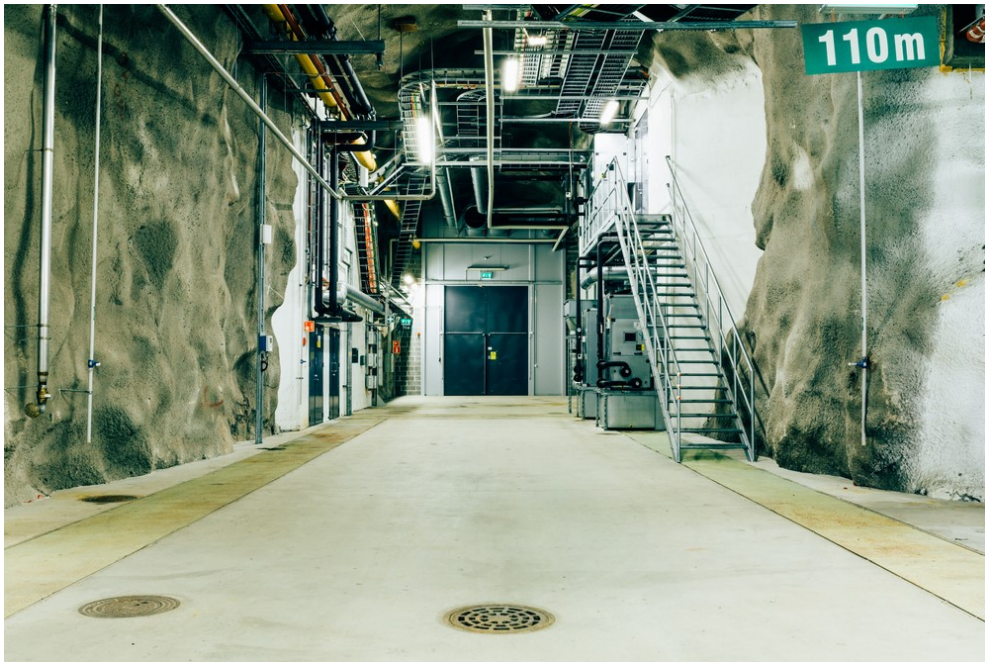
Kuva 10. Katri Valan lämpö- ja jäähdytyslaitoksen toimitiloja. (Aineistopankki, Helen Oy)
