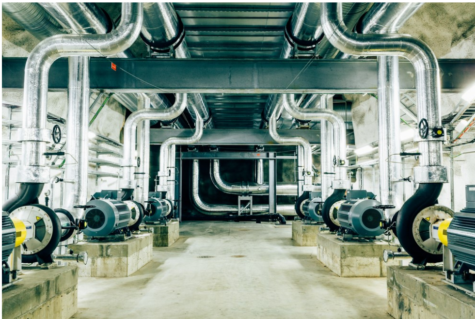
Kuva 9. Katri Valan lämpö- ja jäähdytyslaitoksen teknistä laitteistoa. (Aineistopankki, Helen Oy)
