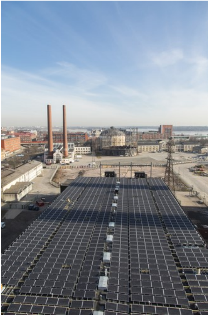
Kuva 11. Suvilahden sähköaseman aurinkokennot. (Aineistopankki, Helen Oy)
