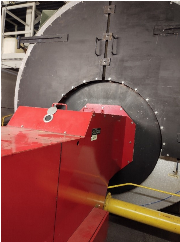
Kuva 5. Tuliputkikattila Radanvarsitien lämpökeskuksessa.
