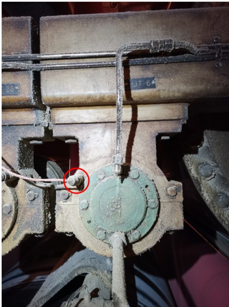
KUVA 9. Kuivausryhmän johtotelan anturointi laakeripukissa
