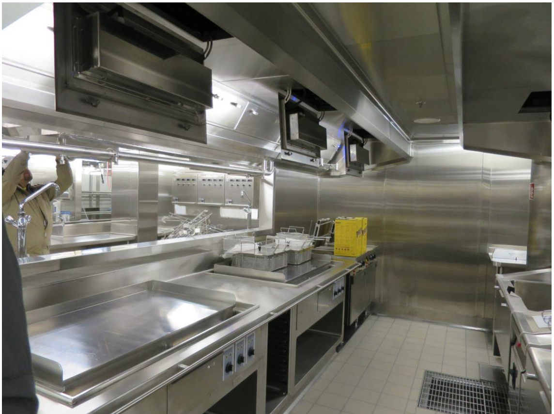
Kuva 21. Valmis UV-Wash Hood huoltoluukut avattuna Mein Schiff 5 -laivan keittiössä asennettuna.
