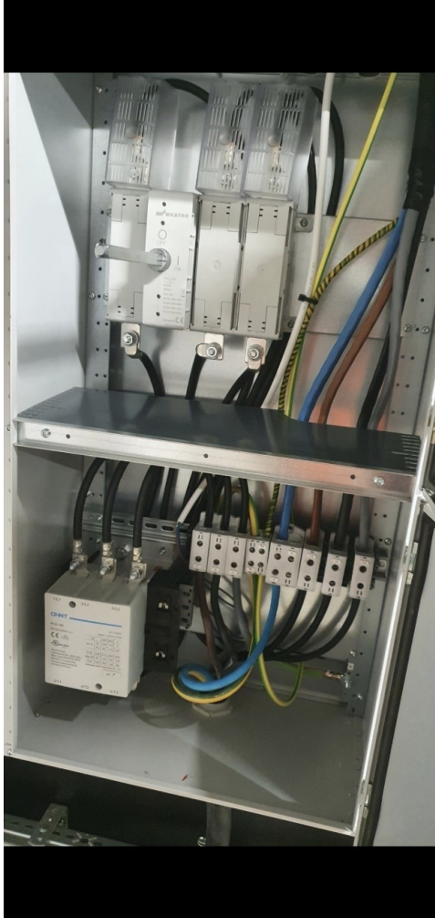
Kuva 6. Aurinkosähköjärjestelmän AC-kytkentäkeskuksen sisäpuoli.
