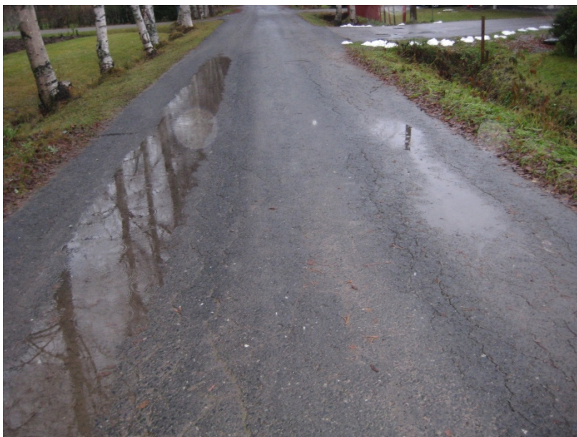
KUVA 4. Painumia ja halkeamia Joonantiessä
