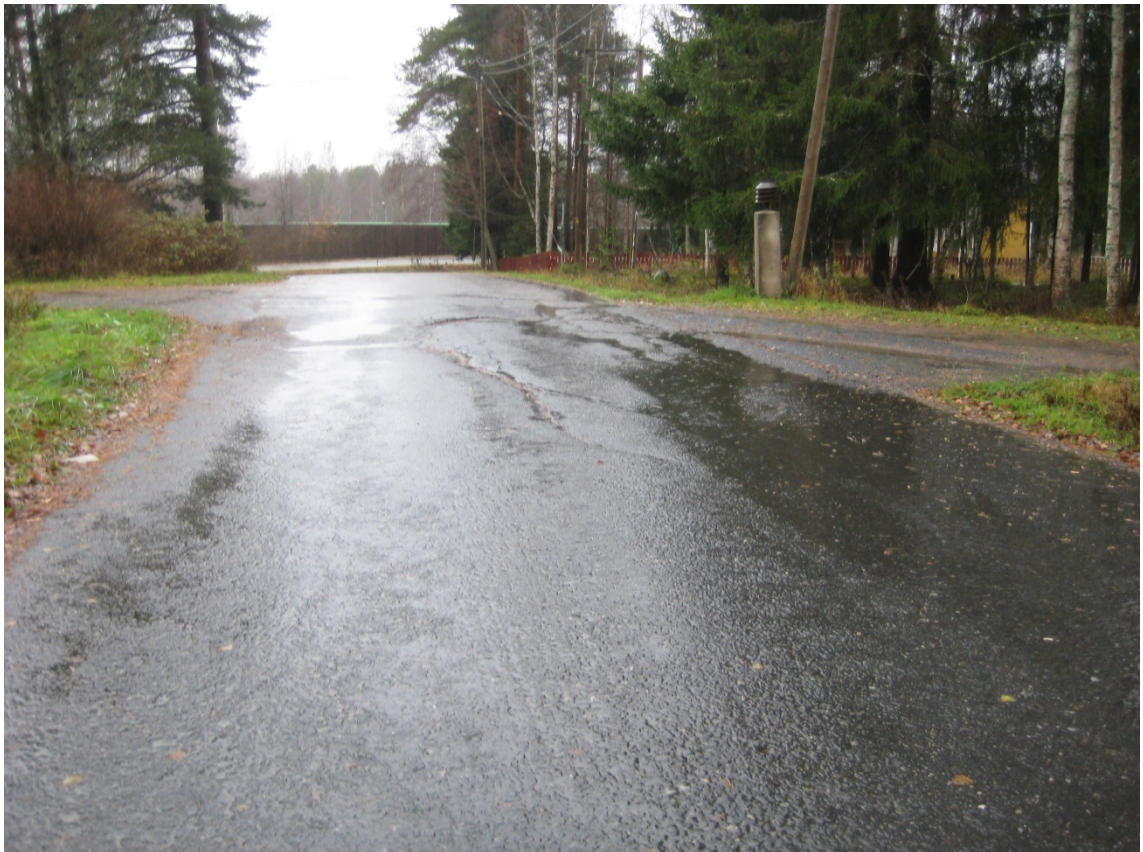
KUVA 6. Vaurioita Saksiontiessä Temmeksellä
