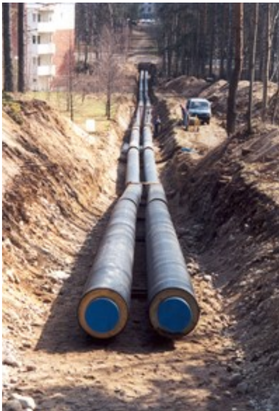
Kuva 2. Kiinnivaahdotettu kaukolämpöjohto. (Kaukolämpöverkot, 2022.)
