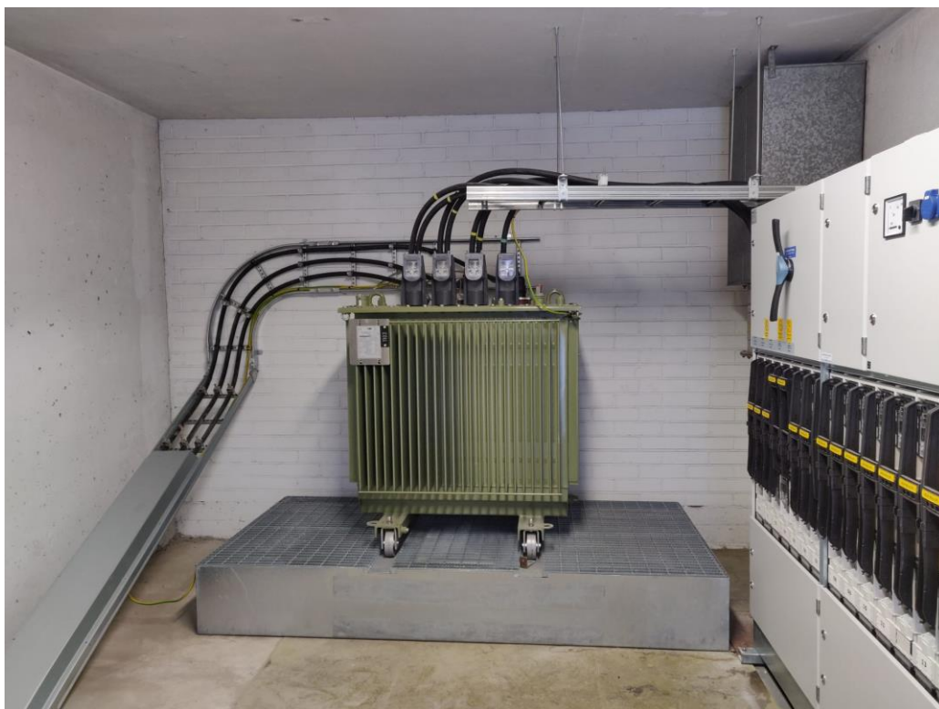
KUVA 2. Asennettu Liekkiloukku® kiinteistömuuntamossa (Kotilainen 2022, CC BY-NC-ND)
