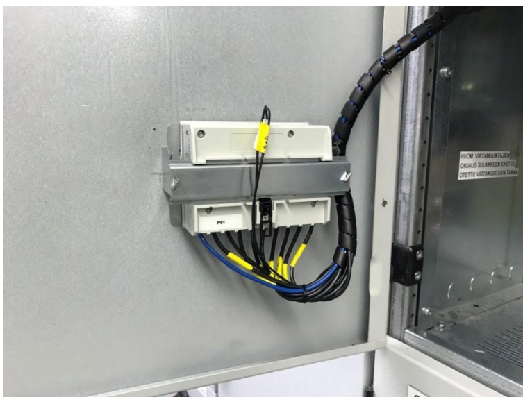
Kuva 27. ABB A44 asennettuna (Pyykönen 2021, CC BY-NC-ND)
