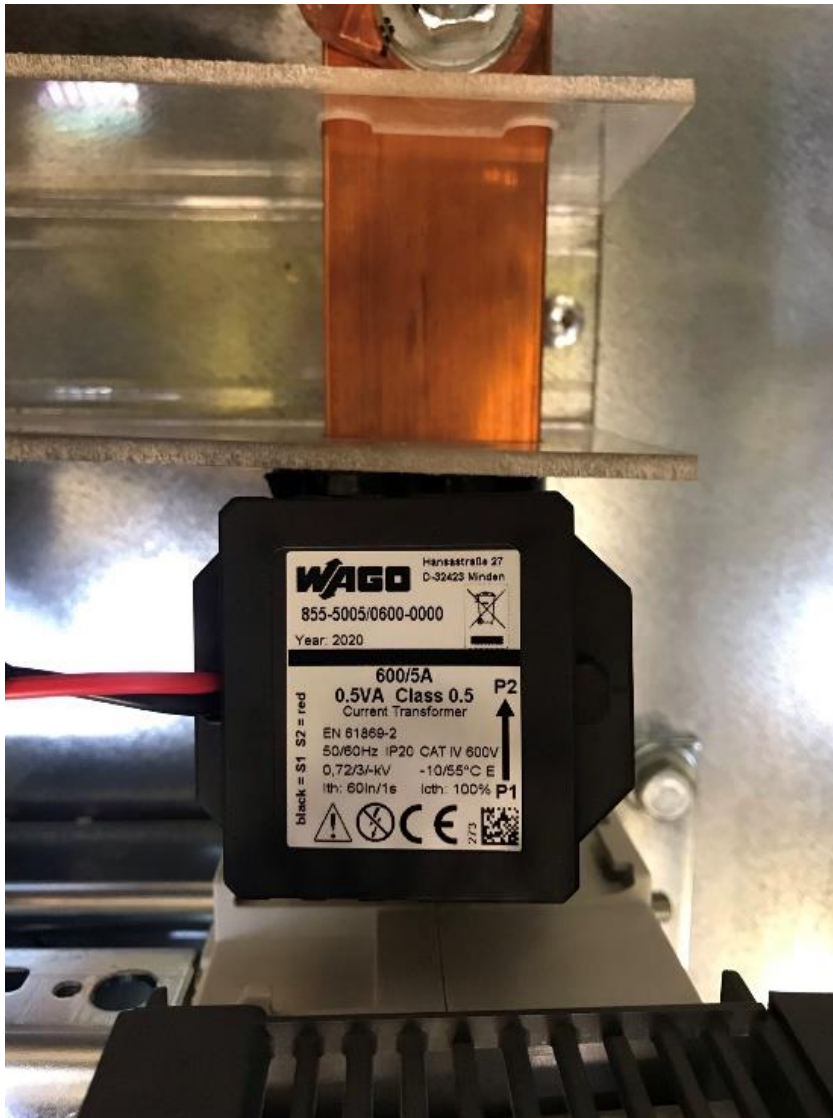
Kuva 25. Wago virtamuuntaja asennettuna (Pyykönen 2021, CC BY-NC-ND)
