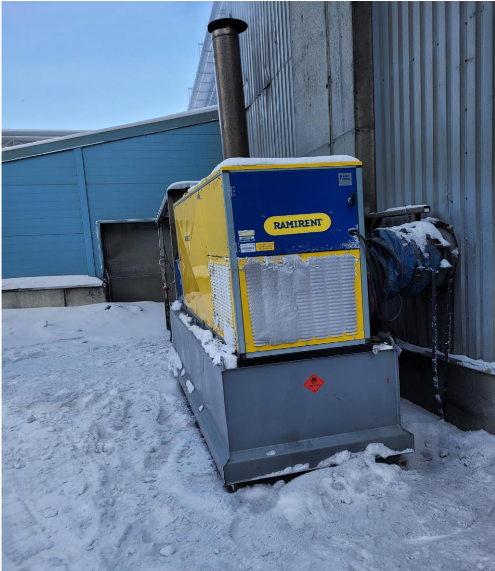
KUVA 5 Välisiilon 1 lämmitys on hoidettu tähän asti polttoainekäyttöisellä lämpökontilla
