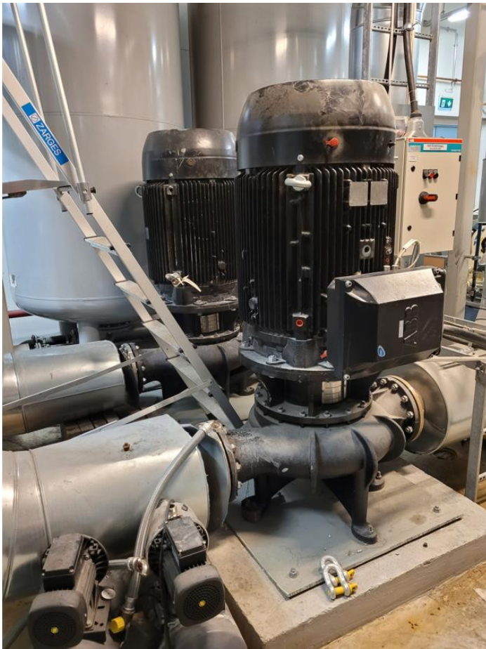
KUVA 2 Kaukolämpöjärjestelmän kiertopumput PU140 ja PU 240
