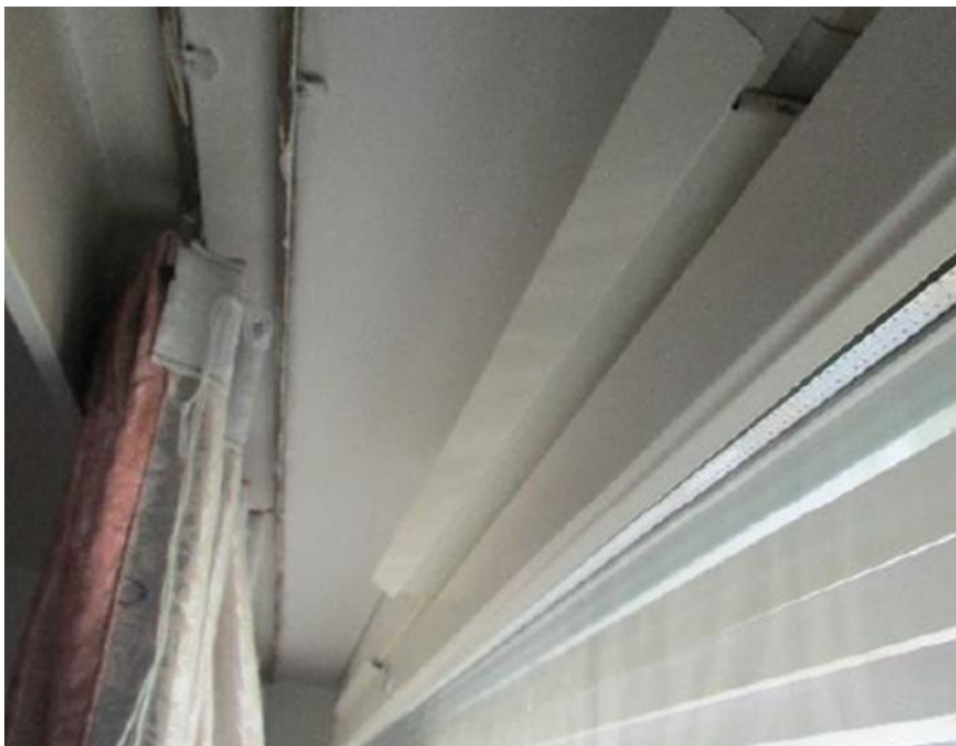
Kuva 8. Ikkunakarmin asennettu korvausilmaventtiili [8]
