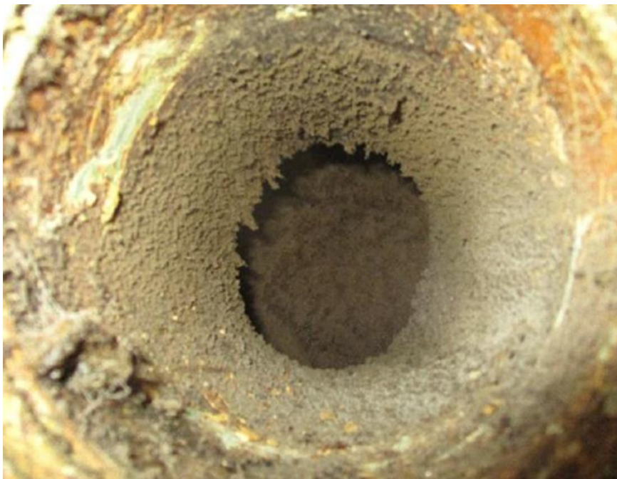
Kuva 9. Yksi kohteen poistoilmakanavista kuvattuna ennen puhdistusta [8]
