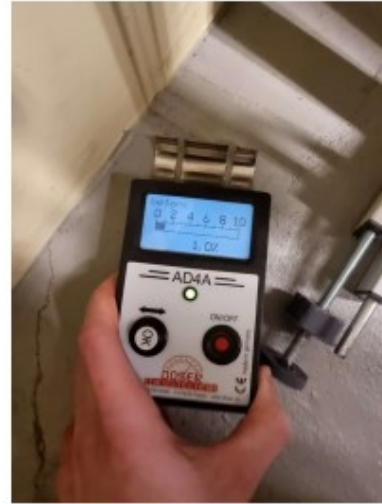
Kuva 17. Kellarin päätyseinän alareuna. Pientä pintakosteutta 1,0 %.
