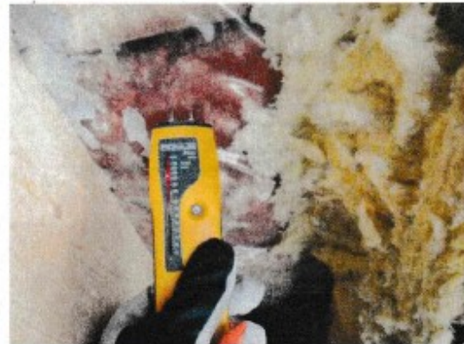
Kuva 31. Pesuhuoneen tiilirivi on kosteana.
