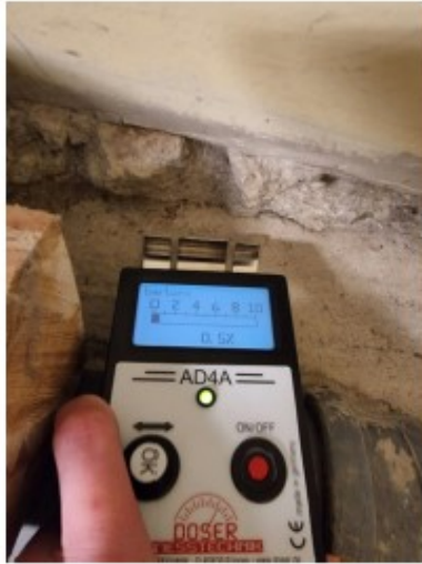
Kuva 16. Kellarin oven viereisen seinän alareuna. Pientä pintakosteutta 0,5 %.
