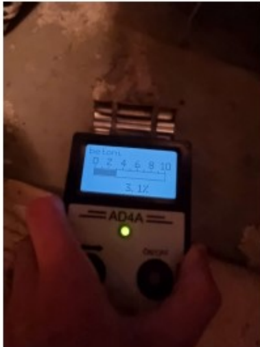
Kuva 20. Kellarin erillistilan lattia. Pientä pintakosteutta 3,1 %.
