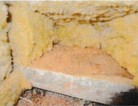
Kuva 27. Pesuhuoneen väliseinän alaosa. Alajuoksupuun sekä työlaatan päällä on sahanpurua.
