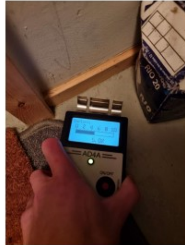
Kuva 21. Kellarin erillishuoneen lattia. Kohtalaista pintakosteutta 5,0 %.
