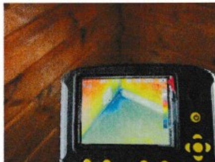
Kuva 11. Takkahuone, TI 35 (korjausluokka. 1). (alin pistemäinen lämpötila 1.2 °C)
