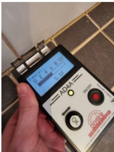
Kuva 22. PH ja Saunan välisen seinän alareuna. Kohtalaista pintakosteutta 5,1 %.
