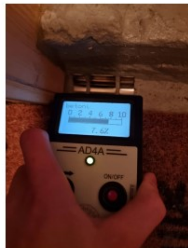
Kuva 19. Kellarin erillistilan kynnyks. Selvää pintakosteutta 7,6 %.
