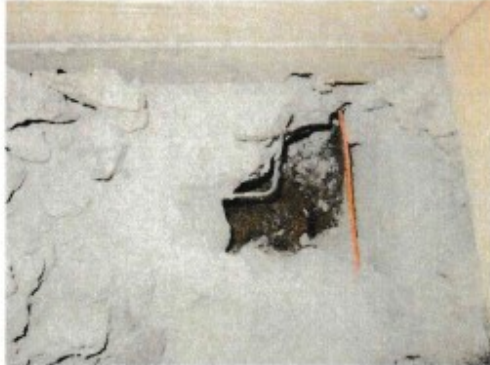
Kuva 22. Työlaatan alla ja sokkelin vieressä ei ollut styrox -eristettä.
