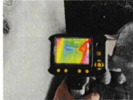
Kuva 8. Mh, TI 63 (korjausluokkasuositus 2). (alin pistemäinen lämpötila 9.4 °C)
