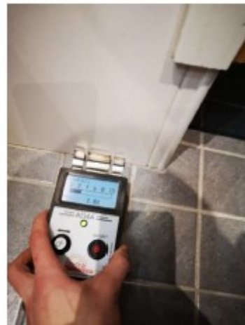
Kuva 2. Vertailukohta saunan oven vieressä, jossa pintakosteus 2,8 %
