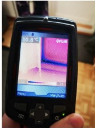
Kuva 3. Terrassin ovesa lämpövuotoa, TI 62. Korjausluokkasuositus 2, alin pistemäinen 10,8 °C.
