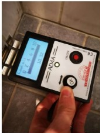
Kuva 1. Pesuhuoneen nurkassa pintakosteus 10,3 %.
