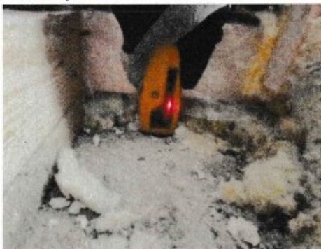
Kuva 21. Reuna-alueella työlaatta on kostea.
