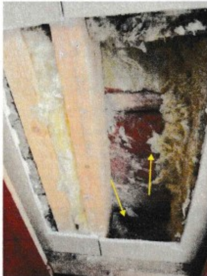
Kuva 30. Suihkunurkkauksen kohta. Kosteat kohdat nuolilla. Alajuoksu on tummunut.
