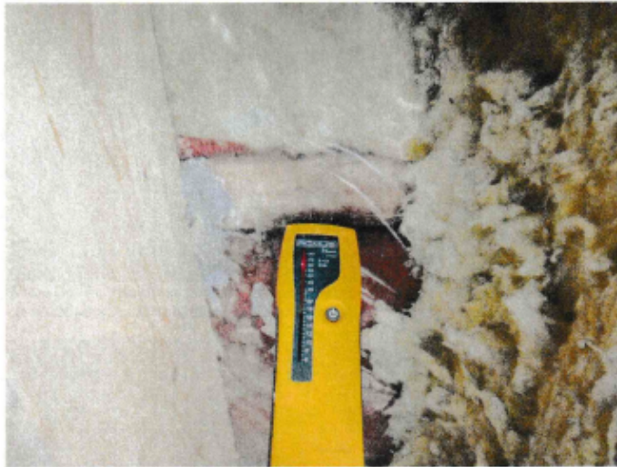
Kuva 32. Tiilirivin päällä oleva koolausrima on märkä.
