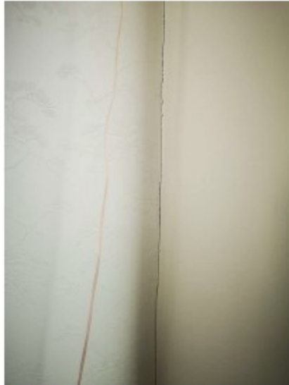
Kuva 5. Olohuoneen nurkassa halkeama. Ei kuitenkaan merkittäviä lämpövuotoja.
