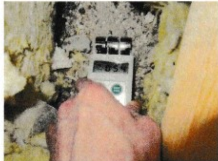
Kuva 14. Työlaatan pinta on kostea (eristevilla on työlaatan päällä).
