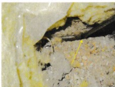
Kuva 16. Työlaatan ja sokkelin välissä on rakoja. Nuolen kohdalla noin 8 mm meisselin pää.
