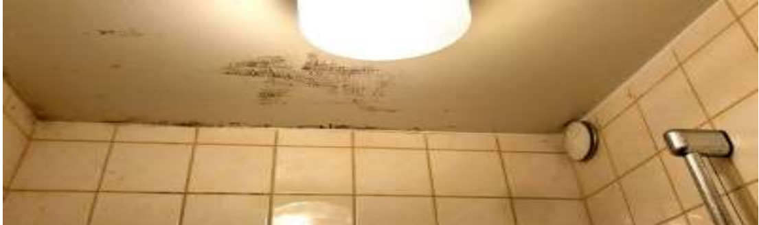
Kuva 3 Homekasvustoa katossa riittämättömästä ilmanvaihdosta johtuen
