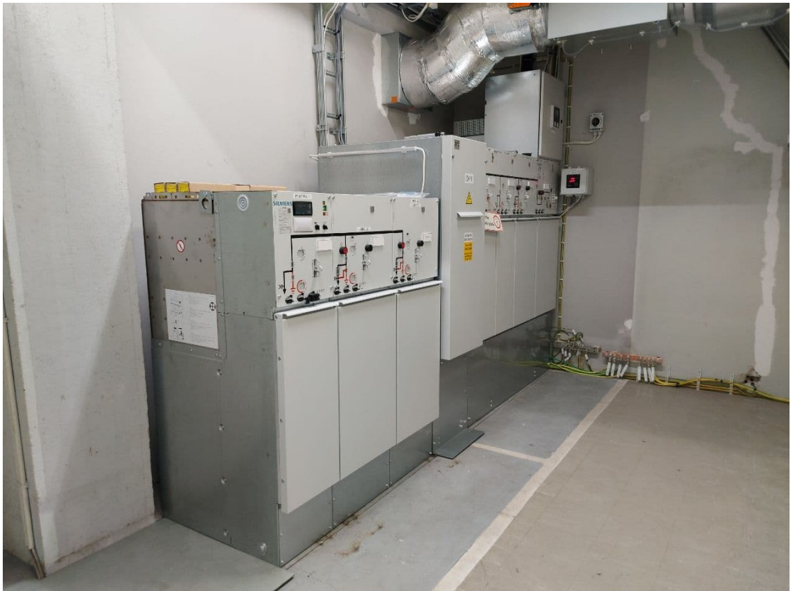
Kuva 11. Sähkötilaan sijoitettu asiakaskojeisto (vasen) ja verkkoyhtiön kytke- mökojeisto (oikea) (18.)
