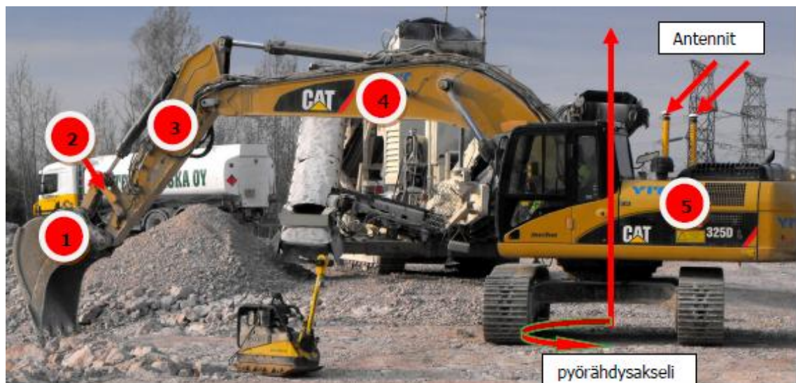
Kuva 8. Koneohjausjärjestelmän anturit ja antennit kaivinkoneessa [2, s 22]
