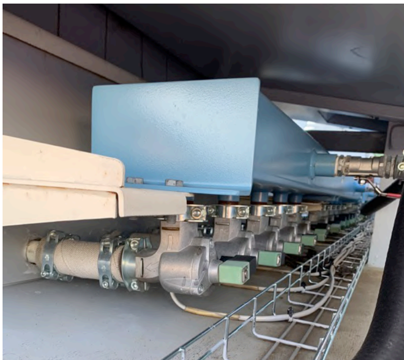
Kuva 13. Paineilmatukin ja paineilmapillien välisiä magneettiventtiilejä.
