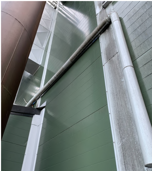
Kuva 9. Eristettyä paineilmalinjaa kompressorihuoneesta savukaasusuodattimelle.
