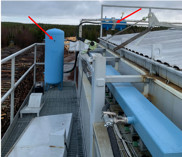
Kuva 10. Taka-alalla savukaasusuodattimen alkuperäinen kokoojakammio (oikealla) ja myöhemmin lisätty toinen kokoojakammio (vasemmalla).
