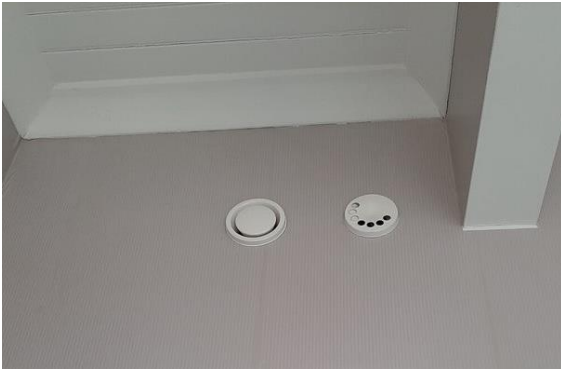
KUVA 20. Vierekkäin sijoitetut tulo- ja poistoilmaventtiilit
