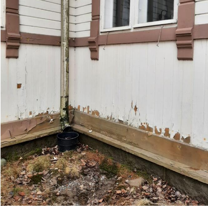
KUVA 13. Vaurioita julkisivun alaosassa syöksytorven kohdalla
