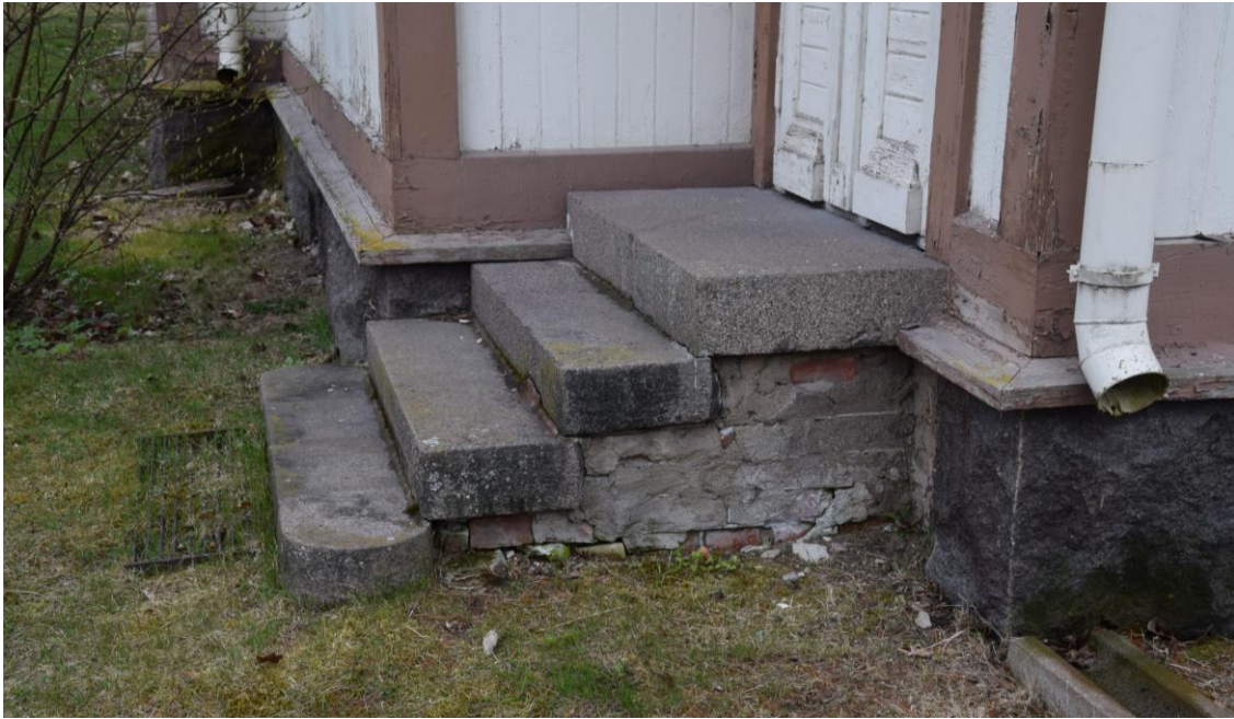
KUVA 10. Vaurioita ulko-oville johtavien portaiden rakenteissa (Tolonen 2021)
