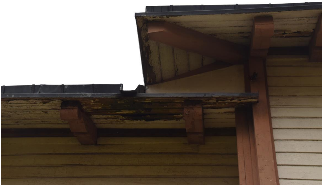
KUVA 12. Vaurioita kaakkoisjulkisivun räystäiden alapinnassa (Tolonen 2021)
