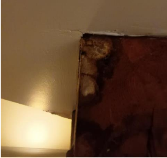
KUVA 24. Vuotojälki ja merkkejä mikrobikasvustosta ristikon tyvessä (Riekki 2021)
