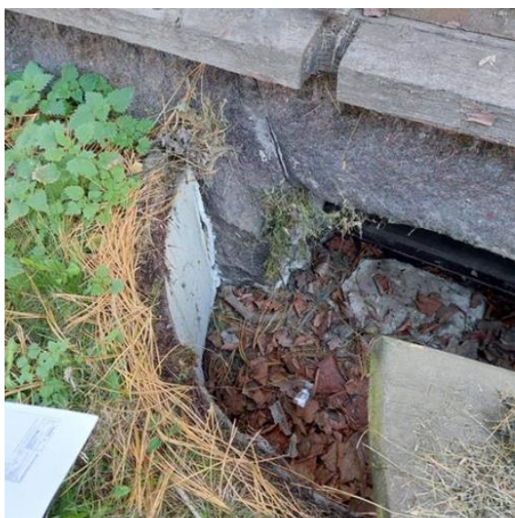
KUVA 23. Kellarin ikkuna kivijalassa (Riecki 2021)
