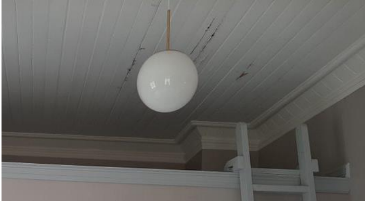
KUVA 17. Kosteusvaurio sisäkattopinnassa lämmönjakuhuoneen alapuolella
