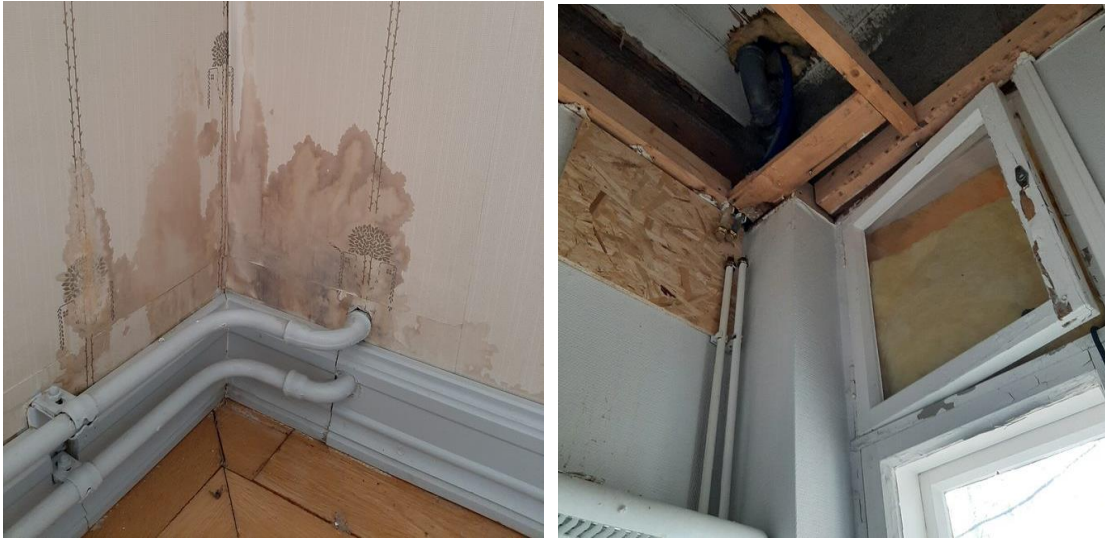
KUVA 16. Kosteusvauriota ensimmäisen kerroksen WC:n takana olevassa huoneessa ja WC-tilan vesiputket ja eristeellä täytetty ikkuna
