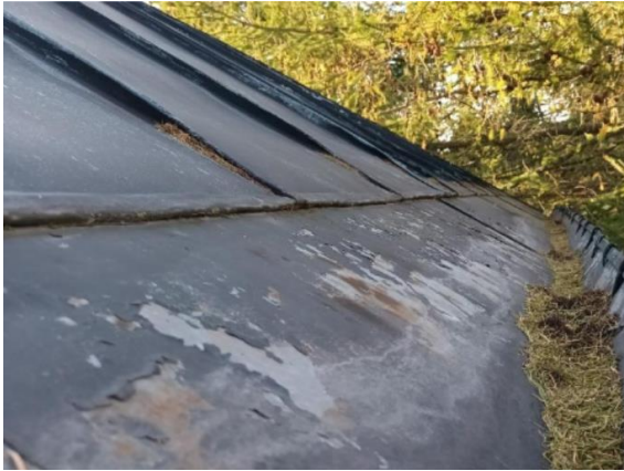
KUVA 21. Peltikatteessa irronnutta maalia ja pintaruostetta ja roskainen jalkaränni (Riekki 2021)
