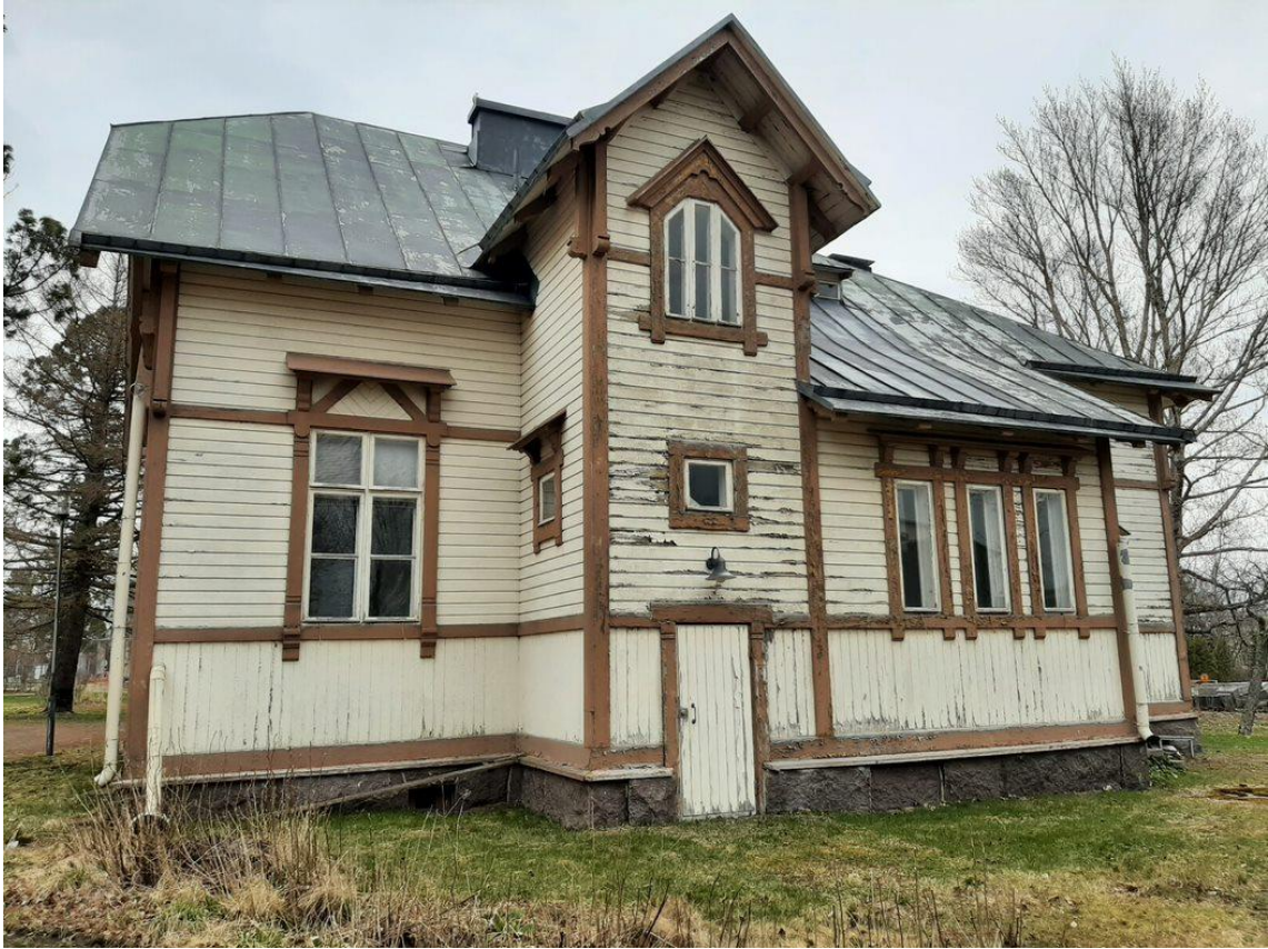
KUVA 14. Päätyjulkisivupinnan huomattava rapistuminen, kellariin johtava ovi lähellä maanpintaa ja pudonnut syöksytorvi vasemmalla
