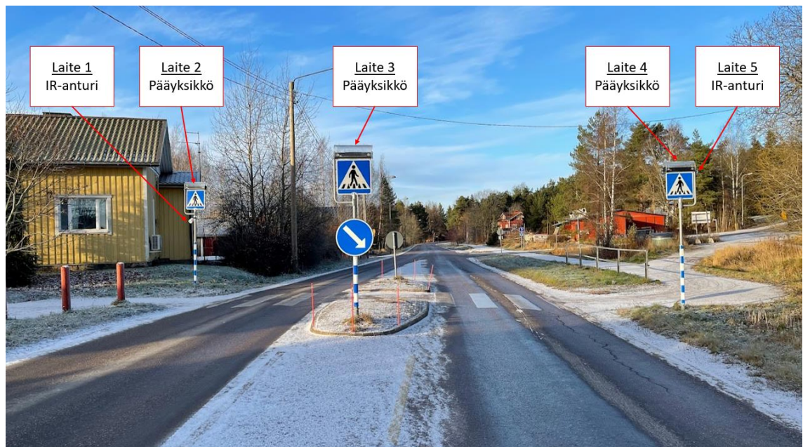
Kuva 16. Suojatien turvajärjestelmä, Vahto, Valpperintie.
