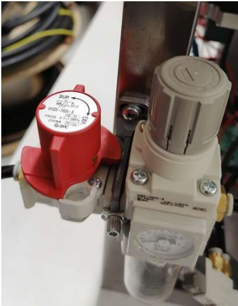
Kuva 19. Ilmanhuoltolaite kiinnitettynä rasvauslaitteen runkoon.
