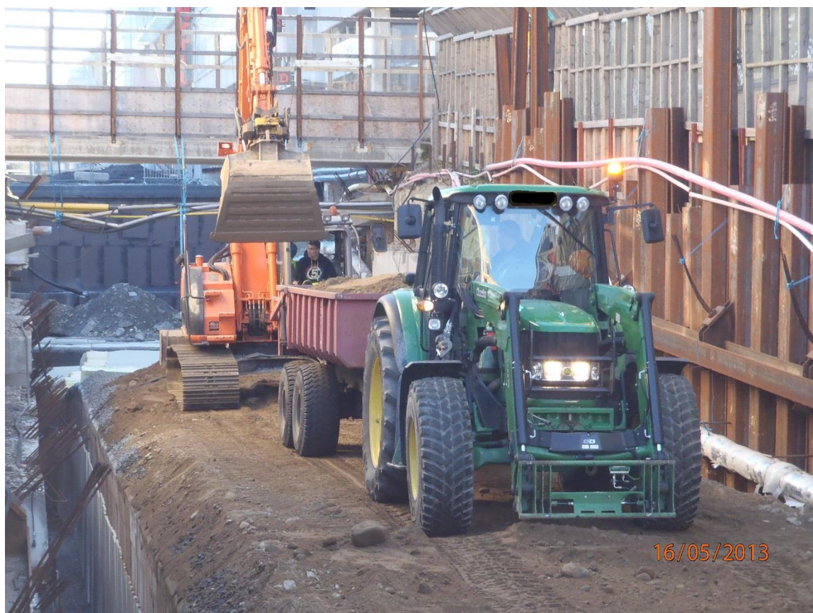
KUVA10. Tunnelin vierustäyttövaiheessa työtilat olivat ahtaat. Konetyöt toriparkin sisäänajotunnelin päällä vaativat äärimmäistä tarkkuutta. (Raatikainen 2013-05-16.)
