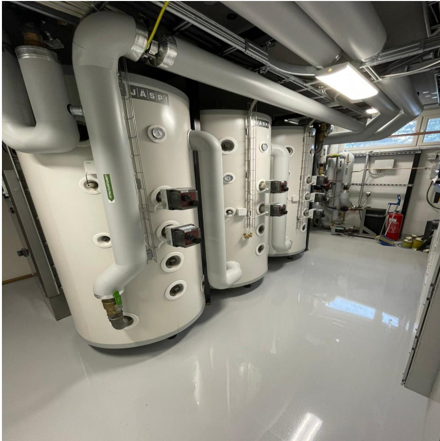
Kuva 12. Käyttöveden ja lämmityspiirin varaajat järjestelmälle
