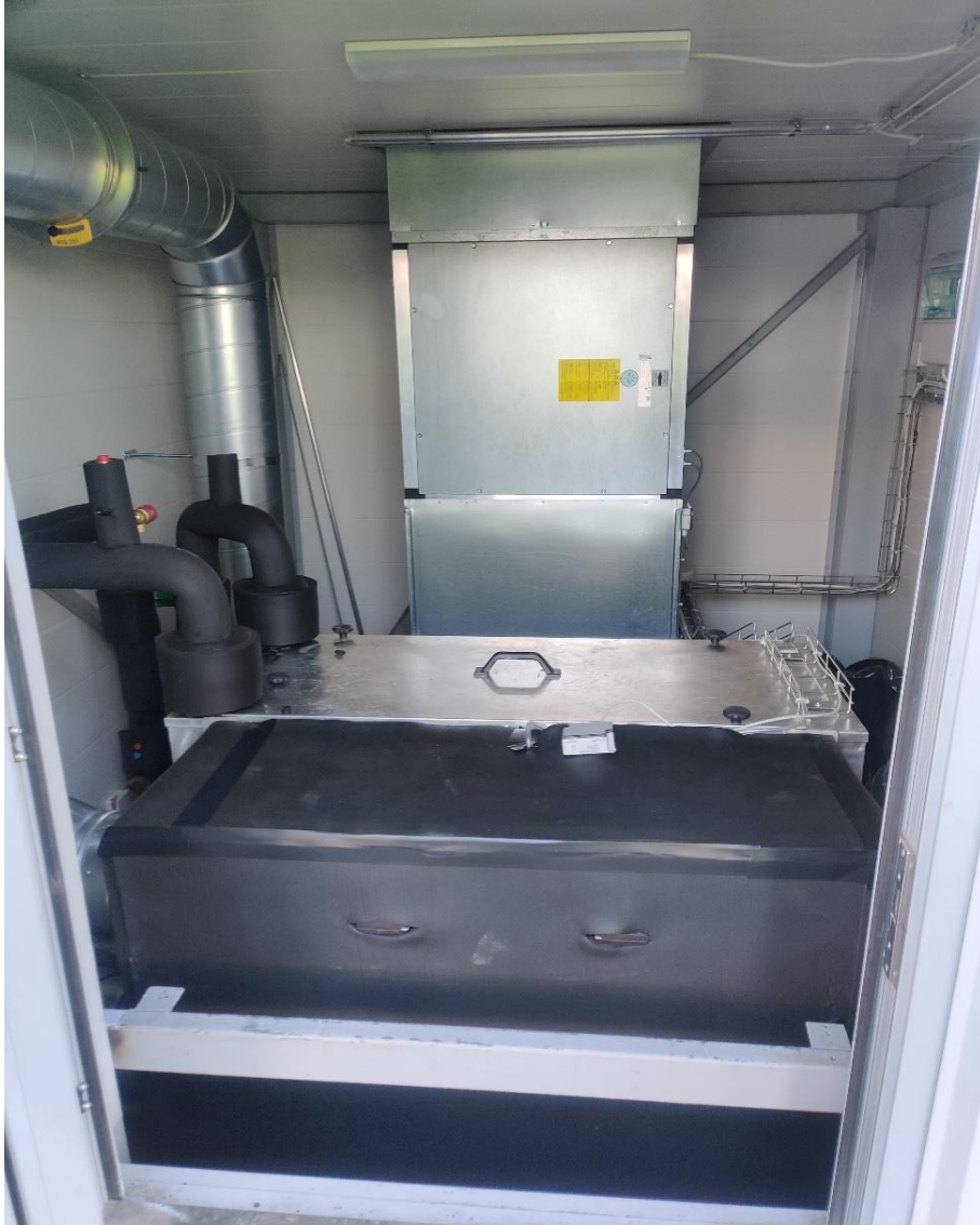
Kuva 11. Vesikatolla sijaitseva puhallinhuone
