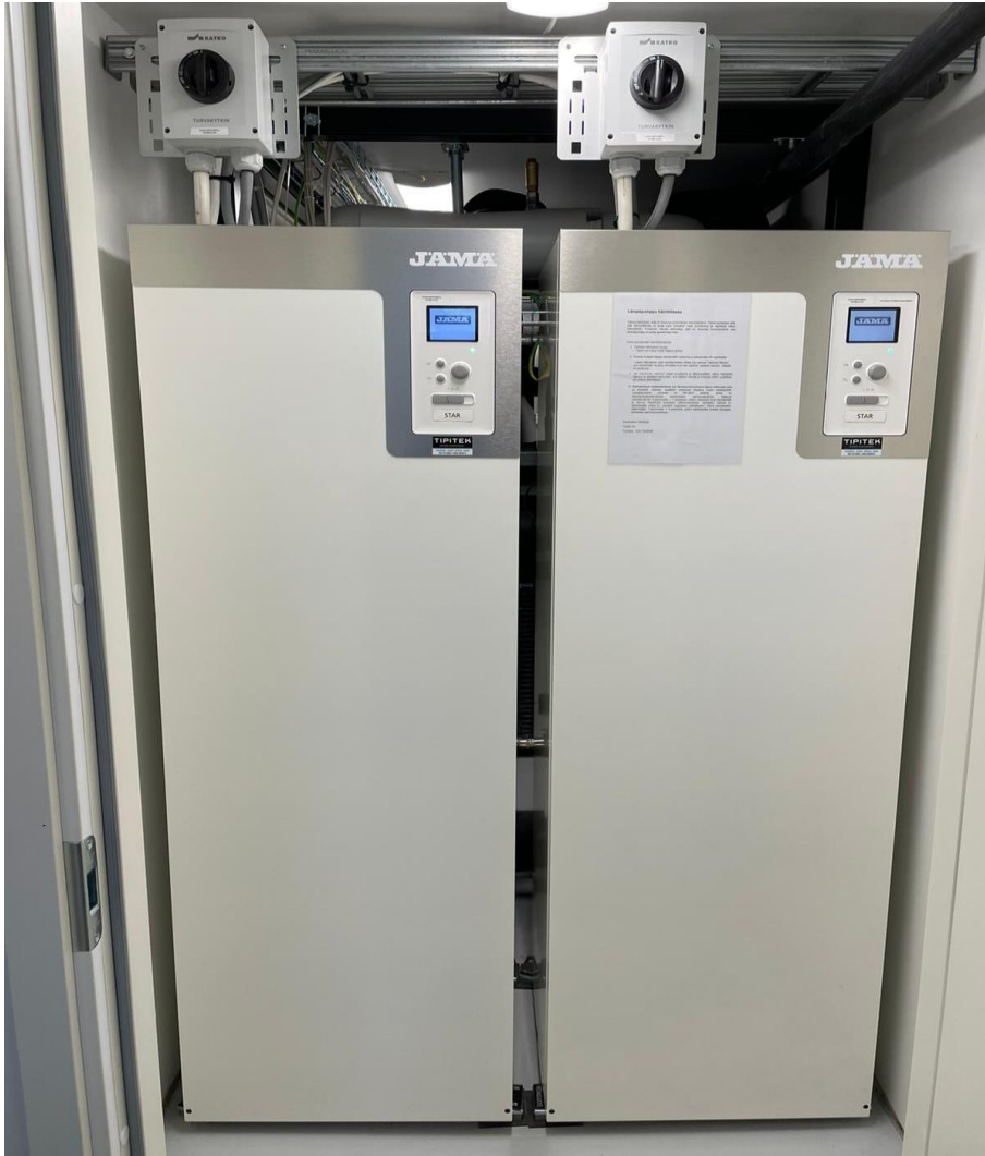
Kuva 10. Jämä Star -lämpöpumppuyksikkö kohteessa
