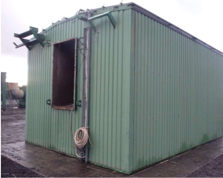
Kuva 4. Pölytalon toinen osa, jossa suodattimet sijaitsevat (Tapojärvi 2022b)
