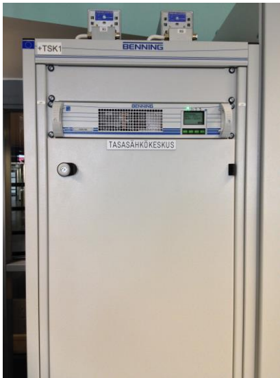
Kuva 9. 110 V akusto ja tasasähkökeskus.
