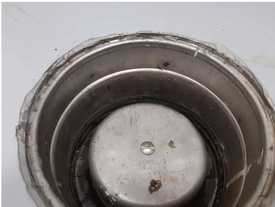
Kuva 19. Lattiakaivo ilman ritilää.
