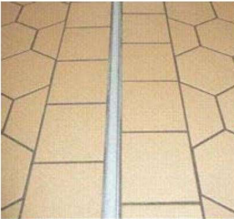
Kuva 3. Esimerkki laattalattian liikuntasaumasta liikennöidyllä alueella (EHEDG 2014b, 54).
