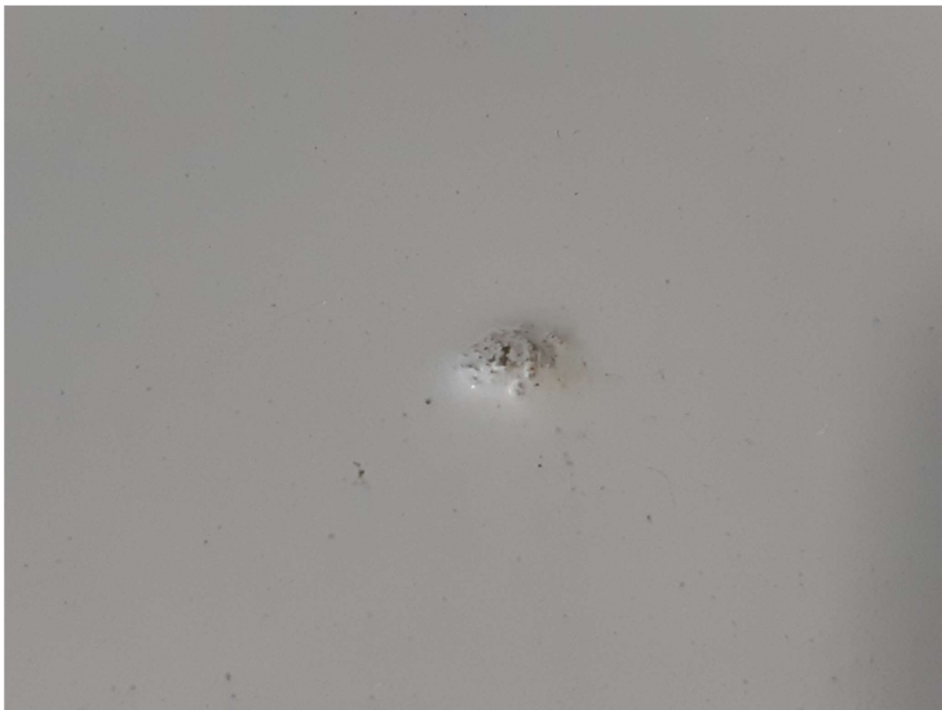
Kuva 14. Lattian pinnan kohouma.
