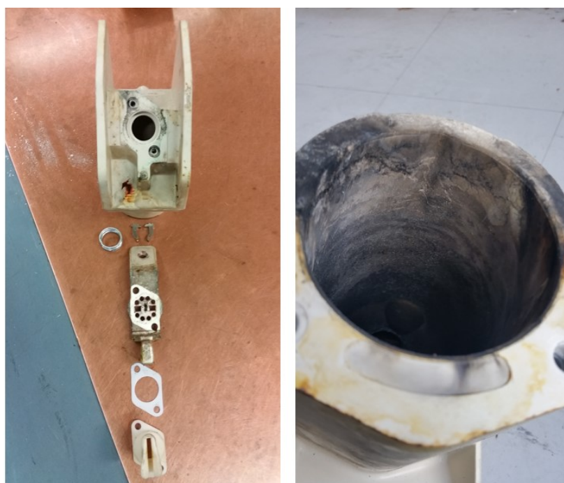
Kuva 38. Vaiheen 1 ylempi eristin purettuna. Eristimen sylinterissä näkyy pintapurkausten jäytämää sähköpuita, sekä läpilyönnin seurauksena tulleita palojälkiä.
