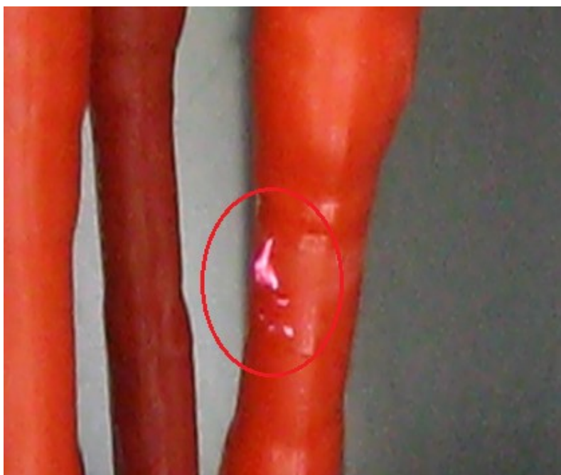
Kuva 10. Pintavirran synnyttämiä kipinöitä kuvattuna 20 kV kaapelipäätteen pinnalla (Paikallis-Sähkö Oy)
