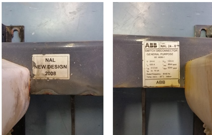
Kuva 37: Erottimen tyyppitiedot. Eristimien pinnoilla näkyy pintapurkausten aiheuttamia jälkiä.
