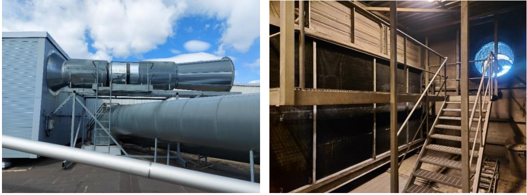
Kuva 3. Poistoilmapuhallin ja Ito-patteri
