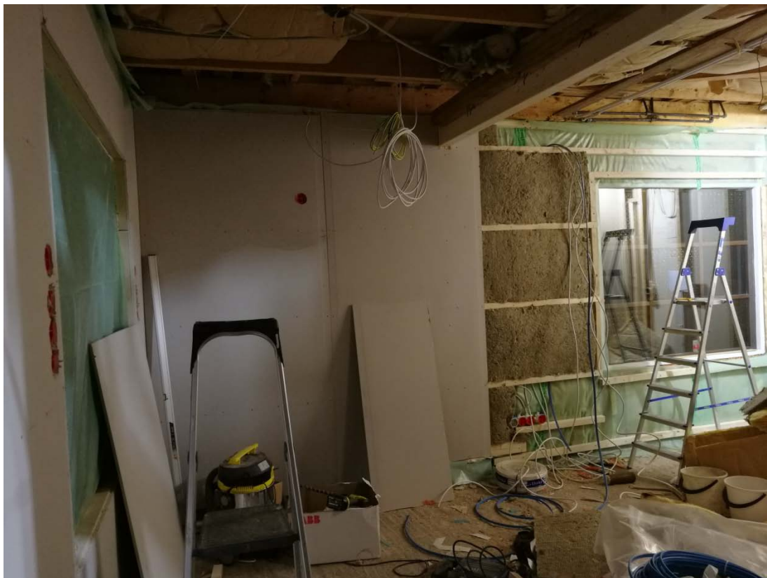
Kuva 8. Kaapelointeja, rasioiden sijoittelua ja lisäeristystä
