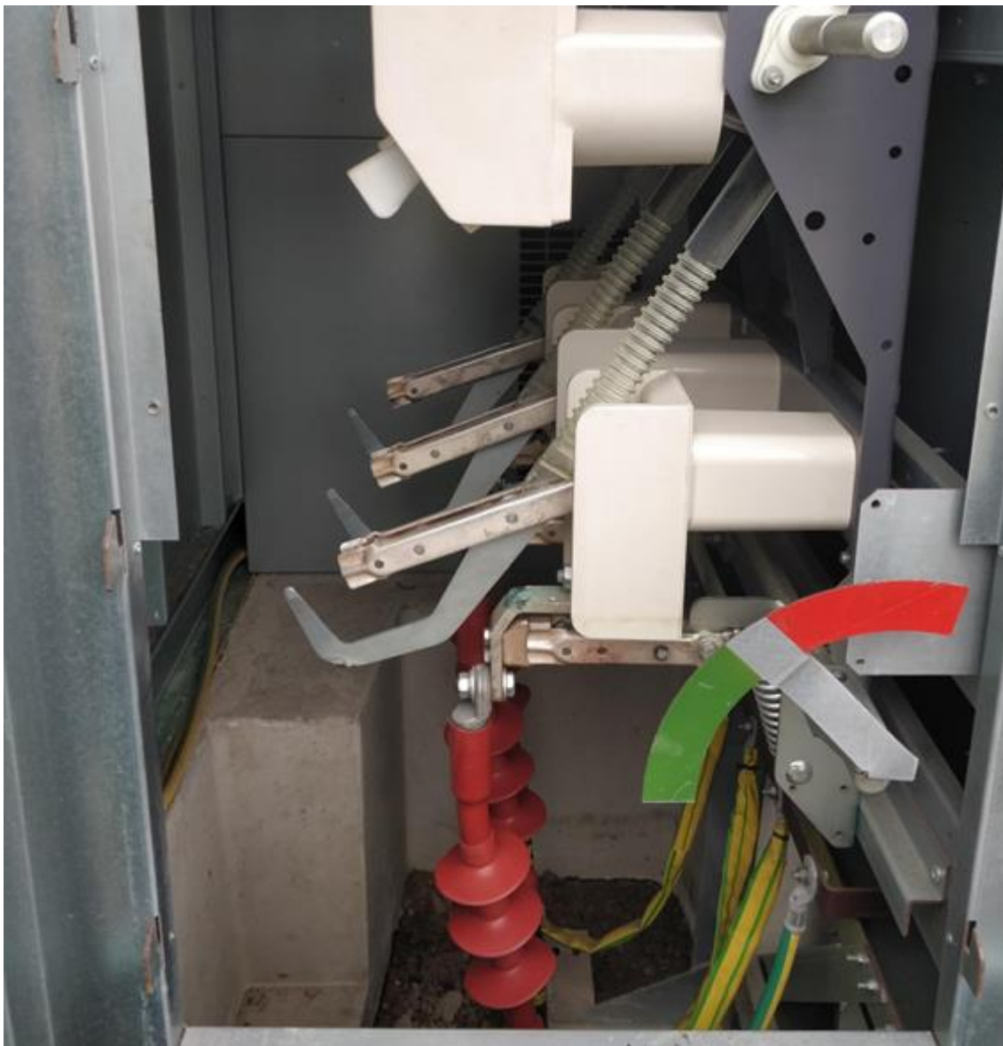
Kuva 2. 20 kilovoltin puhdistettu erotin.
