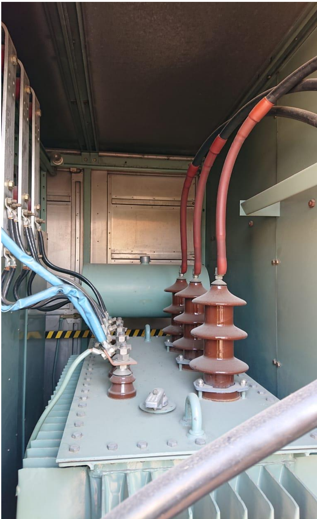
Kuva 3. Kuvassa muuntajatila samasta muuntamosta, missä eristimen läpilyönti oli tapahtunut.
