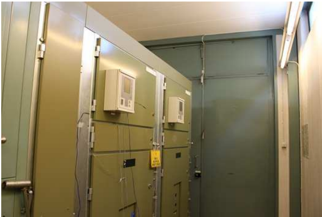
Kuvio 17. Lämpötilan mittaus sähköasemalla
