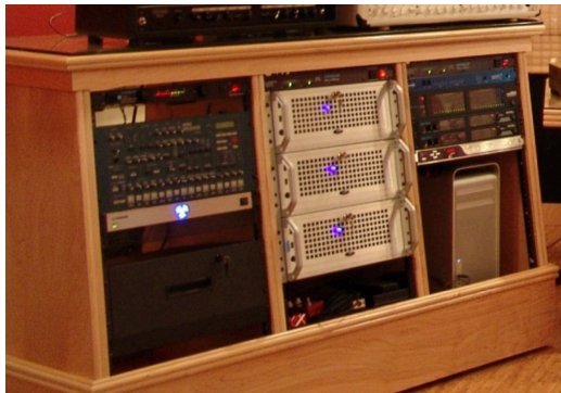
Kuva 8 Käsittelylaitteita työpisteen yhteydessä erillisessä kalusteessa (Steven Klein's Sound Control Room, Inc, www-sivut , haettu 03.12.2013)
