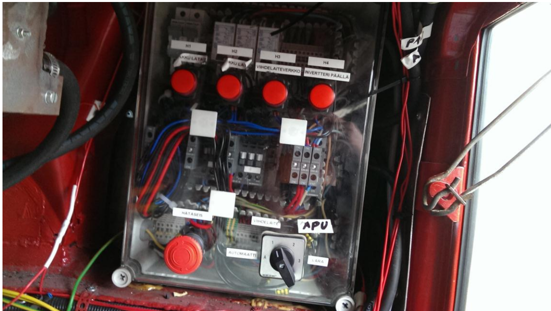
Kuva 9. Latauksenohjauskeskus OK01 (Lintula 2014)
