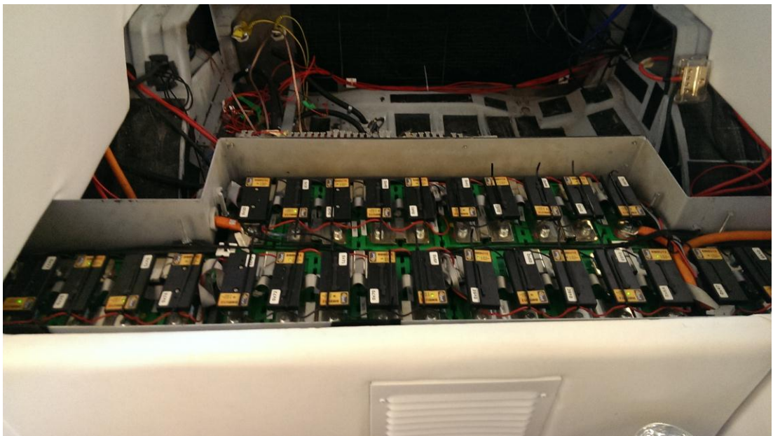
Kuva 4. Takimmainen akkukotelo (Lintula 2014)
