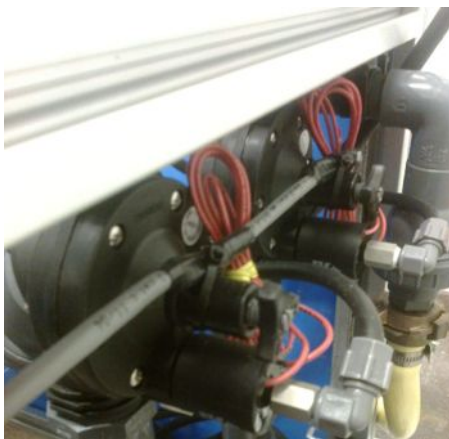
KUVA 26. Bermand PM - 10 -venttiilit ja virtausmittarit. (kuva: Pekka Kähkönen).
