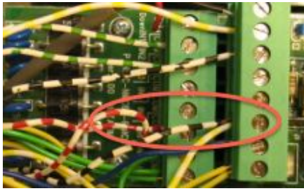
KUVA 17. Digital input -kortti ennen kytkentämuutoksia. (kuva: Pekka Kähkönen.)
