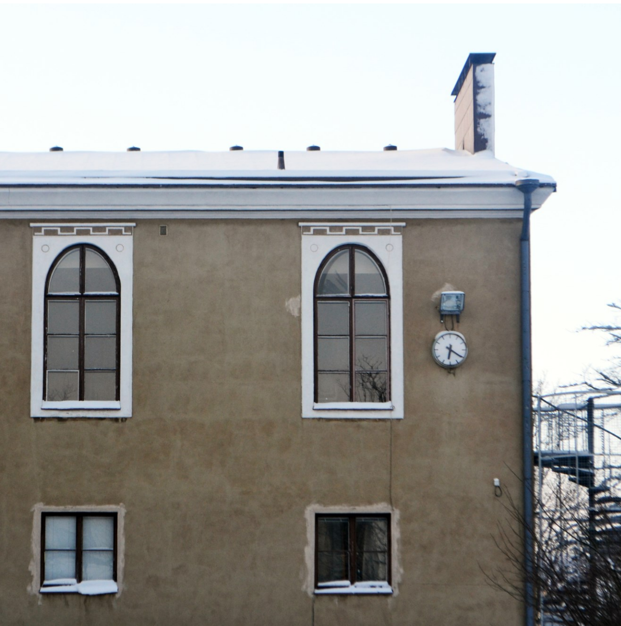
Kuva 7 Rapatussa julkisivussa on käytetty kontrastina vaaleita rapattuja yksityiskohtia ja koriste-aiheita kaari-ikkunoiden yhteydessä. Rappauksessa on havaittavissa paikoittain ikkunoiden ympärillä sijaitsevia vaurioita.
