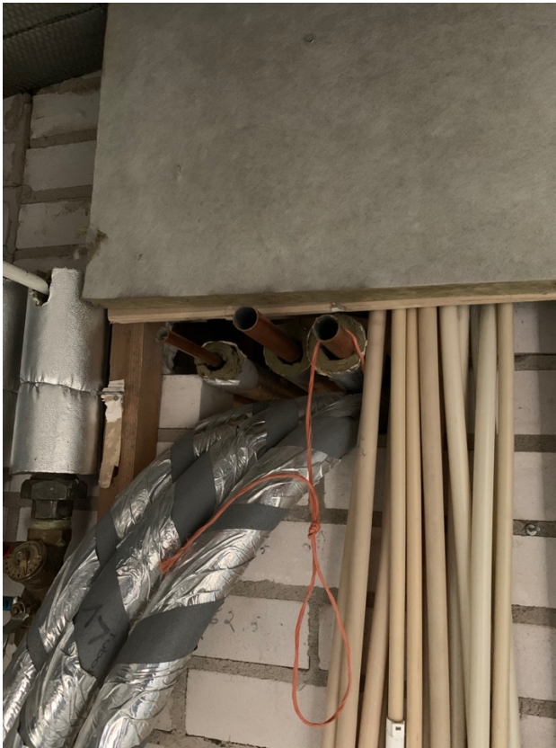
Kuva 11. Auki oleva palokatkoseinä, johon jätetty katkaistut kupariputket paikoilleen, sekä kannakointi on puutteellinen.
