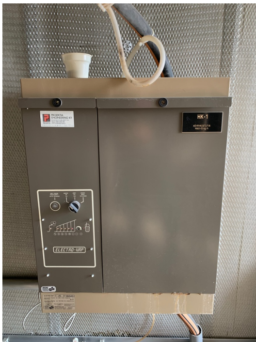
Kuva 16. Iv-konehuoneessa sijaitseva höyrykostutin.
