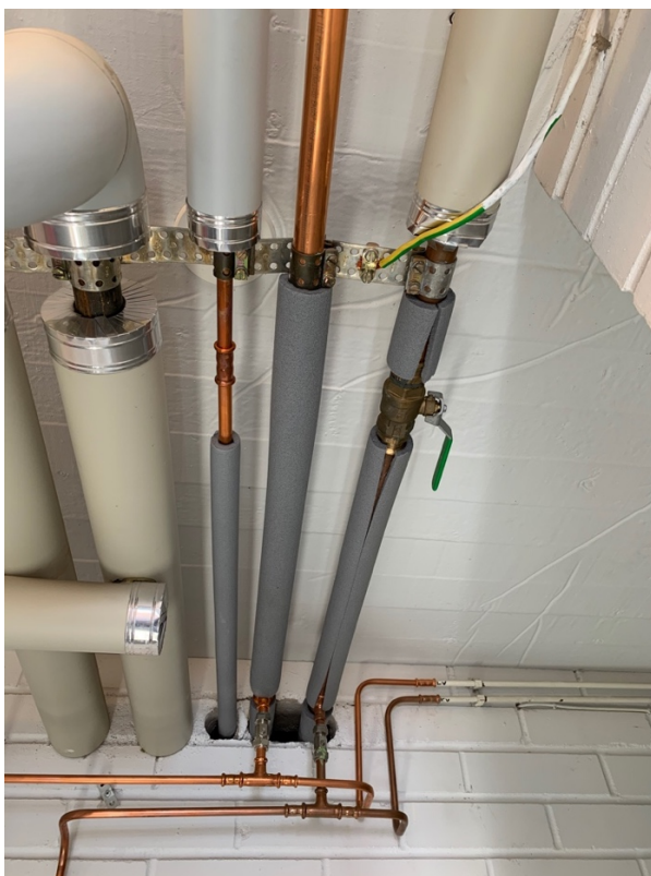
Kuva 10. Puutteellista eristystä käyttövesiputkista lämmönjakohuoneessa, sekä siitä näkee miten putket olisi pitänyt eristää.
