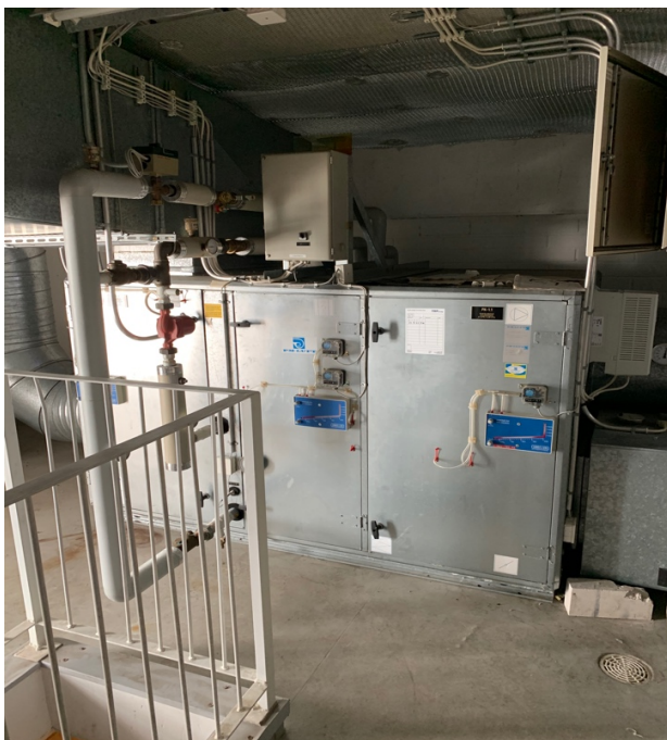
Kuva 15. Ilmanvaihtokone oli hyvässä kunnossa ulkoapäin.
