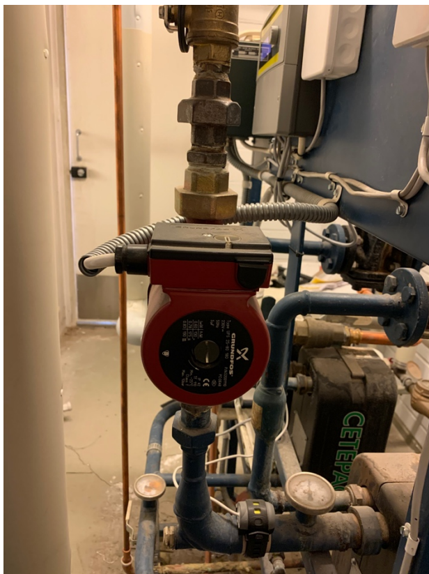
Kuva 1. Grundforsin lämmitysverkoston kiertovesipumppu.
