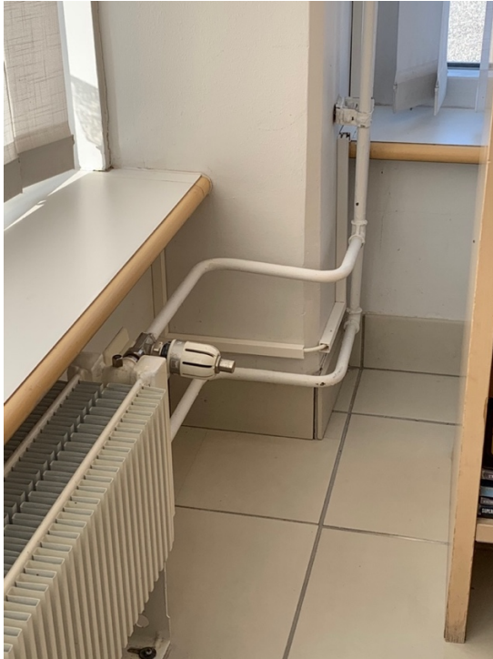
Kuva 2. Lehtisalin lämmityspattereri Rettig Ratec ja termostaattinen patteriventtiili Oras.
