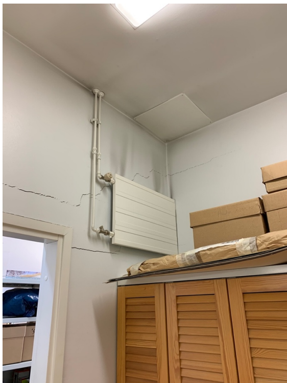
Kuva 14. Naisten pukuhuoneen patteri, joka on liitetty lämpimän käyttöveden kiertoon.
