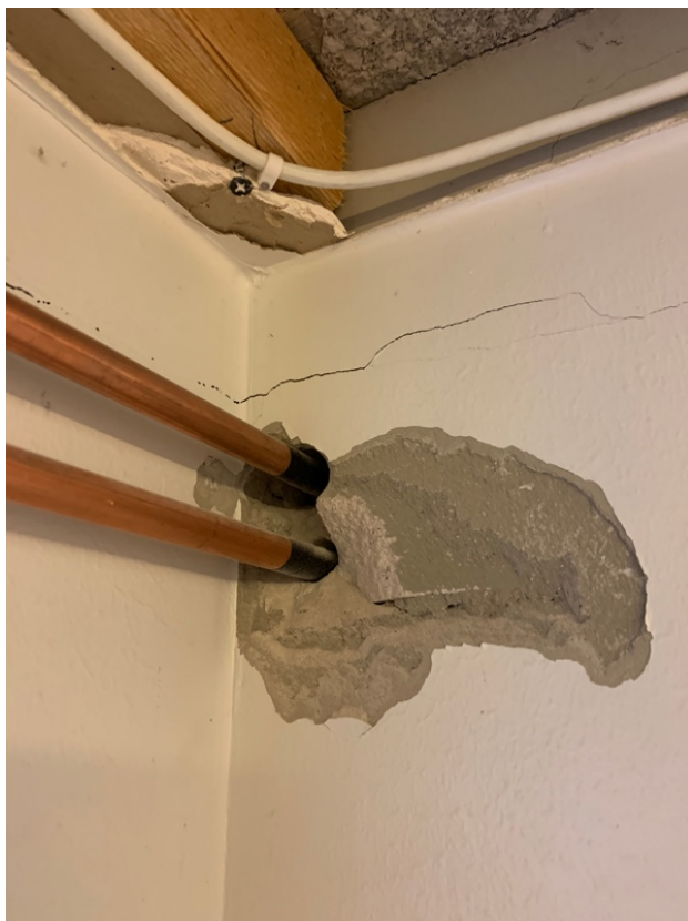
Kuva 9. Huonosti tehty läpivienti, jossa suojaholkki on korvattu teipillä.
