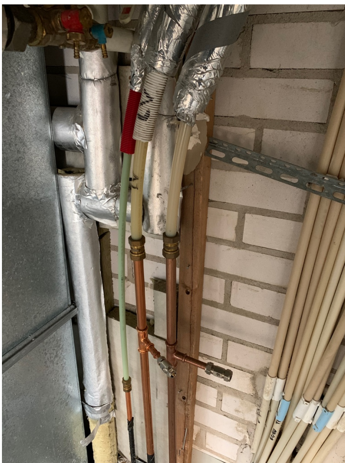
Kuva 6. Käyttövesiverkoston kupariputket liitetty PEX-muoviputkiin.
