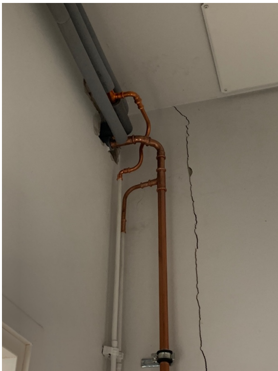
Kuva 7. Lähivuosina uusittua kupariputkea.
