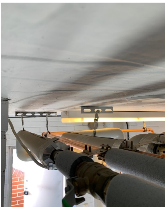
Kuva 8. Lämmönjakohuoneessa toteutettu kannakointi.
