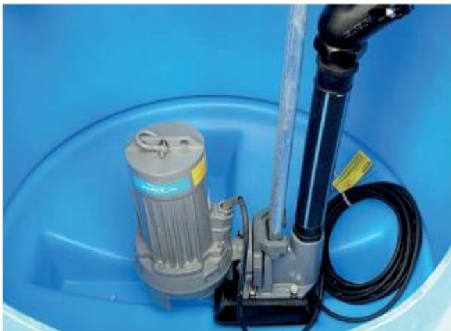
KUVA 8. Kiinteistökohtainen pumppukaivo sisältä (RT-kortti 66-11133)
