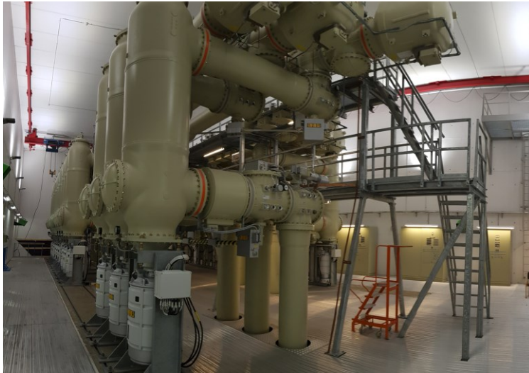
Kuva 8. 400 kV GIS-kytkinlaitos Vantaan Tammistossa Kuva. [27]
