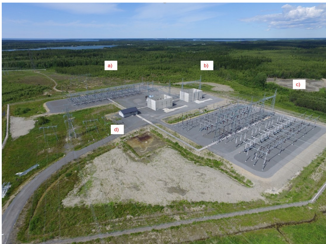
Kuva 4. Kristinestadin muuntoasema a) 110 kV kytkinlaitos b) muuntajat suojiineen c) 400 kV kytkinlaitos d) valvomorakennus [27]
