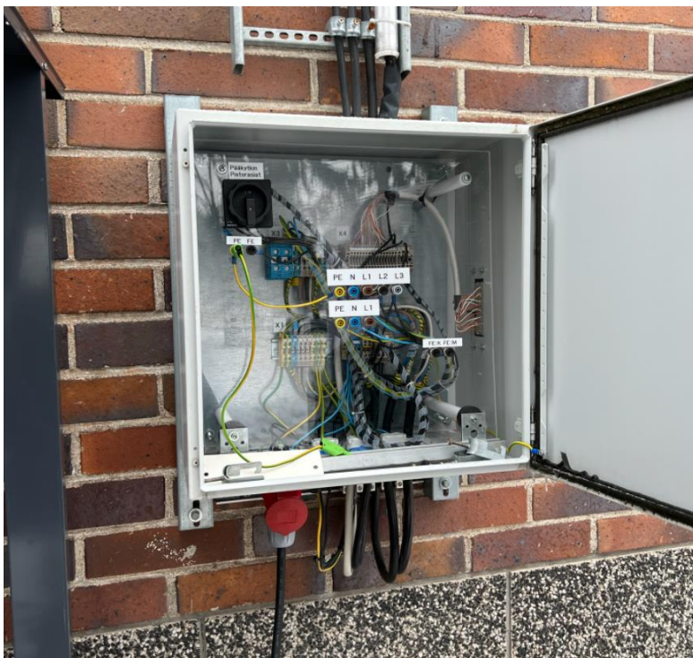
KUVA 7. Laboratorion ulkoseinällä sijaitseva kytkentäkotelo.
