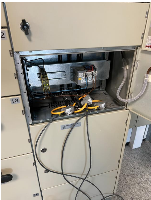
KUVA 21. Virtamittaukset laboratorion pääkaavion nousukaapeleissa.
