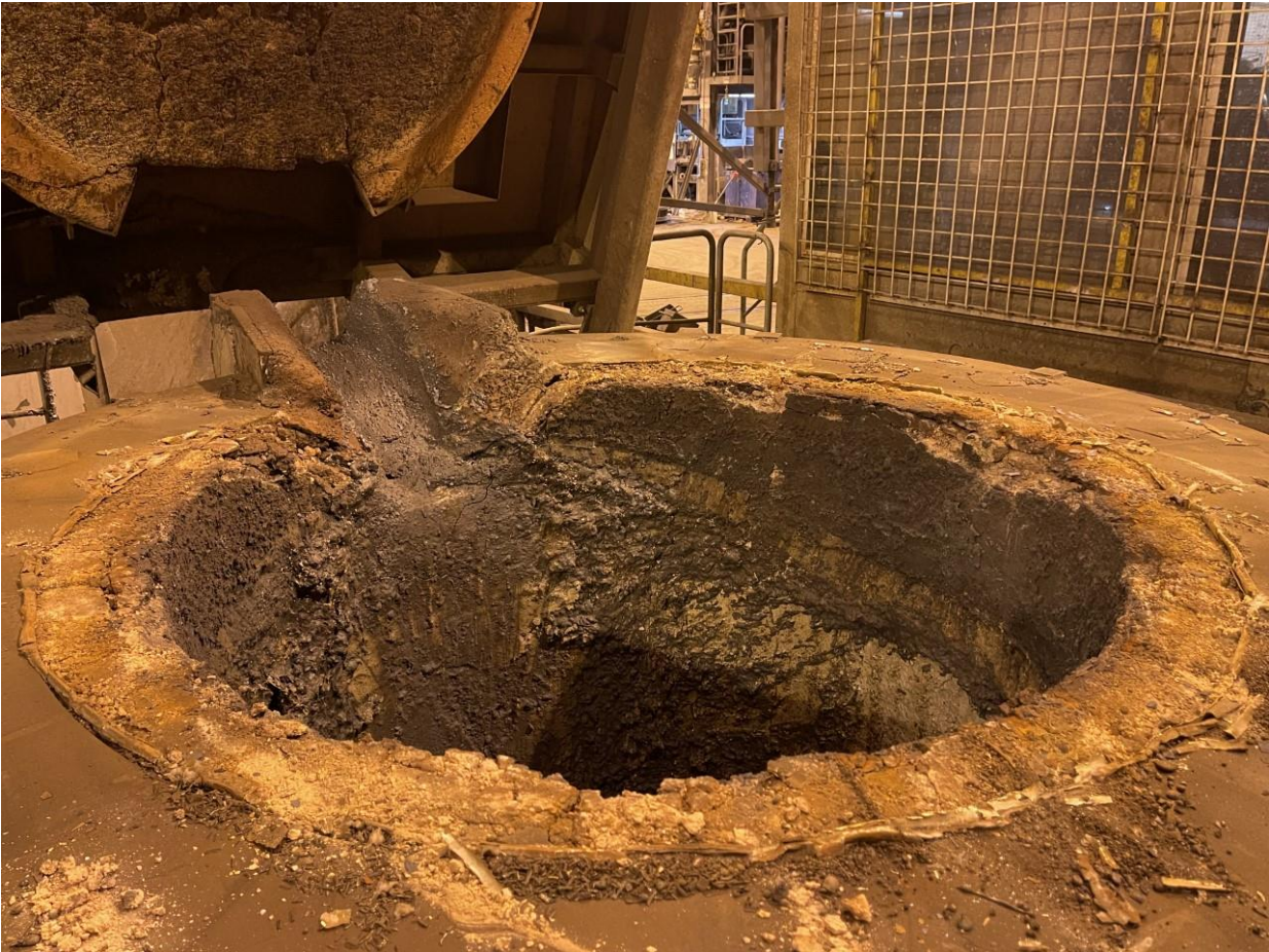
Kuvio 19. Silikamassalla ylös asti vuorattu uuni, jossa vauriota yläosassa.
