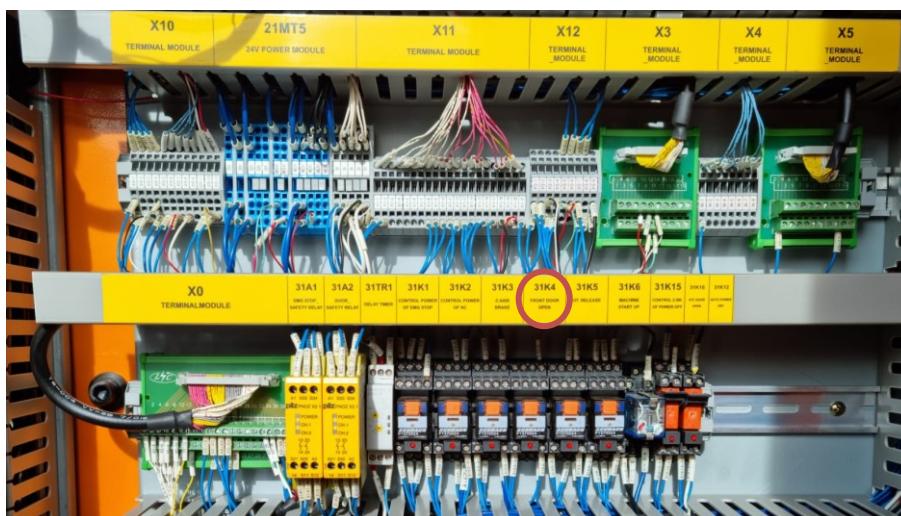
Kuva 11. Quaser-työstökeskuksen sähkökaappi ja 31K4-rele korostettuna.
