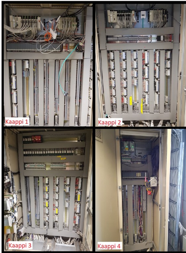
Kuva 9 Tornion Voima Pirkkiö laitesijoittelu
