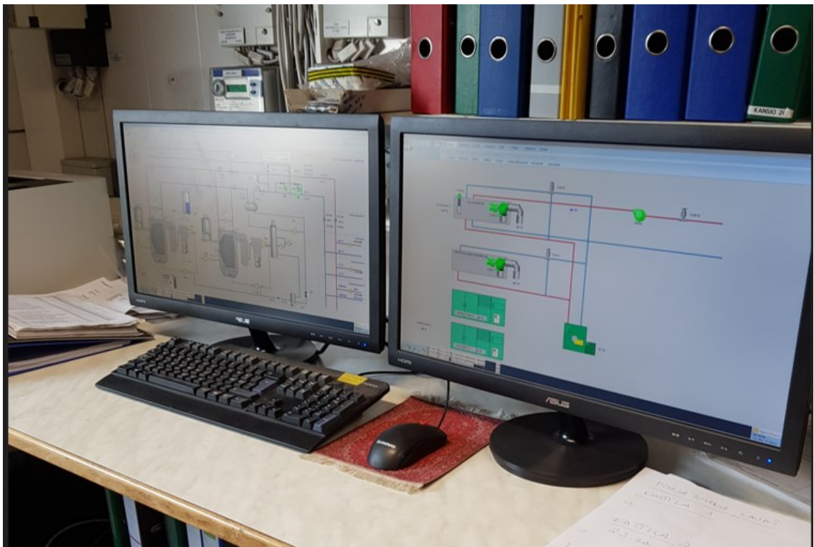
Kuva 7 Tornion Voima Pirkkiö OPS1
