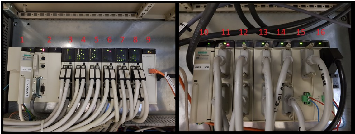
Kuva 11 Tornion Voima Pirkkiö Logiikka 1
