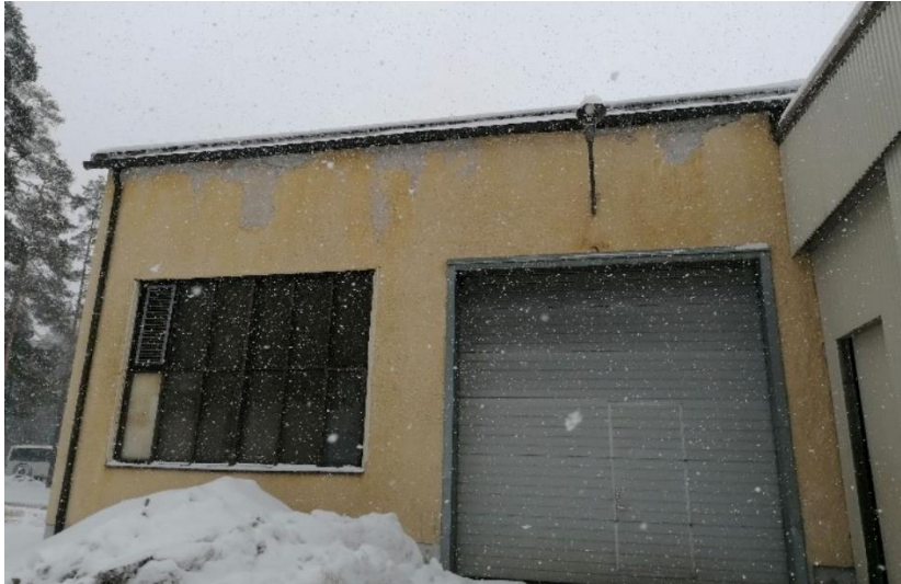
Kuva 8 . Rakennuksen julkisivussa nähtävää kulumaa. Kuvan oikeassa reunassa nähtävissä länsipuolella sijaitseva kylmä, peltinen varastolaajennus.
