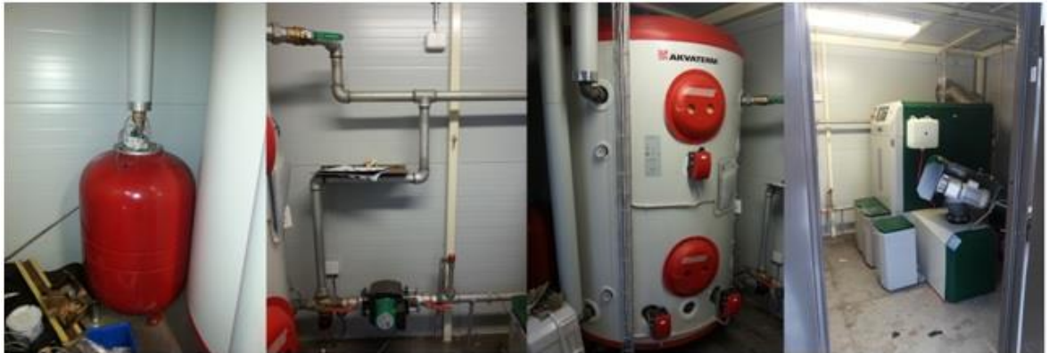
KUVIO 3. Kattilahuoneen laitteistoa
