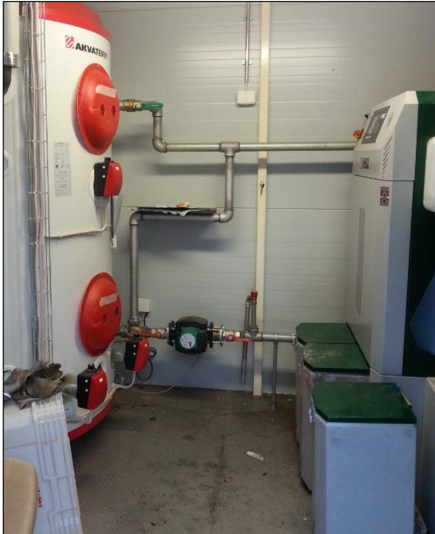
KUVIO 26. Kattilan ohjausyksikön läheisyydessä oleva eristämätön lämminvesiputkisto
