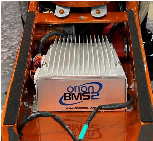
Kuva 24. Orion BMS 2 kytkettynä ja kiinnitettynä takahäkin sisään
