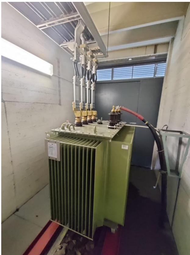
Kuva 22. ABB:n muuntaja 10 \pm 2 \times 2,5\% /0,4 kV 1600 kVA
