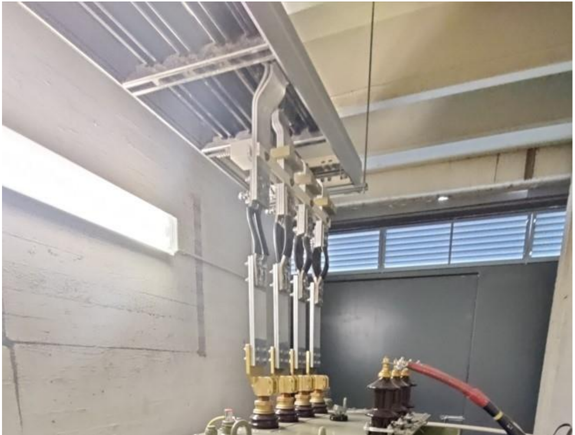
Kuva 25. Syöttö muuntajalta sähköpääkeskukselle on toteutettu alumiinisilla virtakiskoilla
