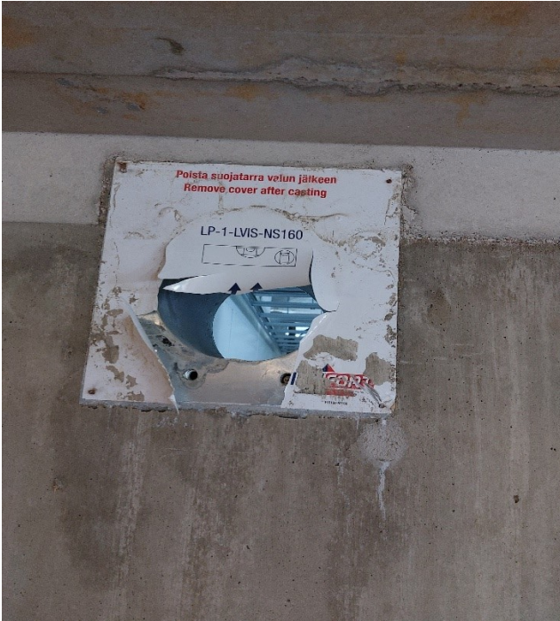
Kuva 8. Metallinen LP-1-putkiläpivienti ilmanvaihtokanavalle väestönsuojaa ympäröivässä seinässä.
