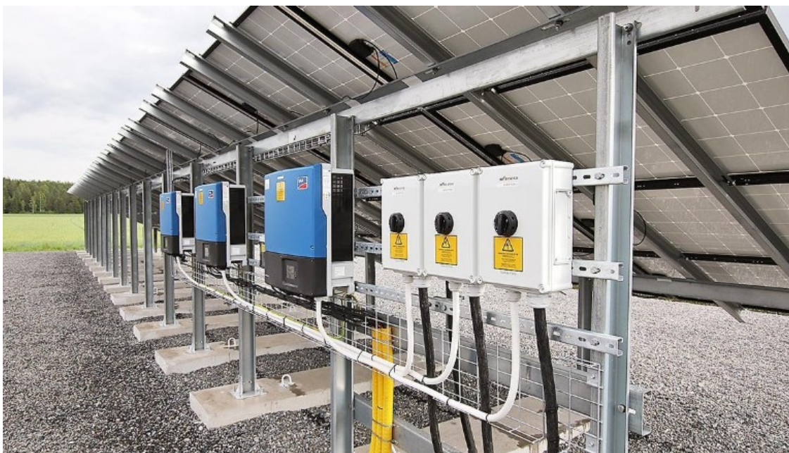
Kuva 10. Invertterien ja turvakytkimien sijoitus maahan asennettavassa järjestelmässä. (Maaseuduntulevaisuus.2022).
