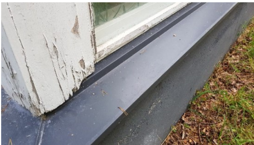
Kuva 9. Lahonnut ikkunan karmi
