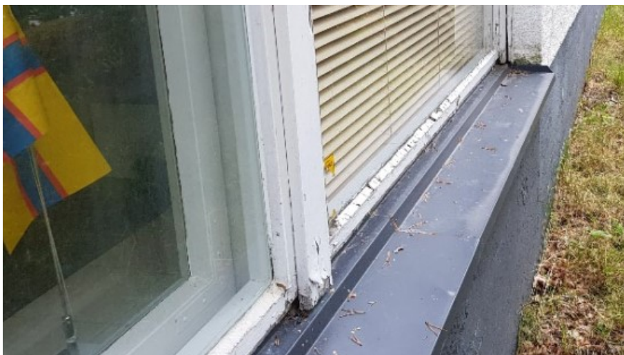
Kuva 8. Riittämättömät kallistukset pellityksessä
