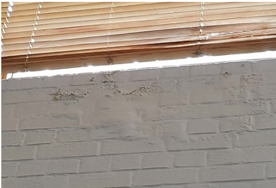
Kuva 10. Kirkkosalin seinän kosteusvaurio
