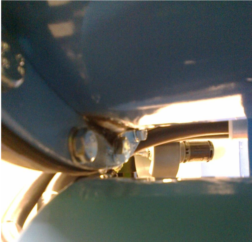
Kuva 31. Vuotokohta alhaalta ensimmäisen korjauksen jälkeen
