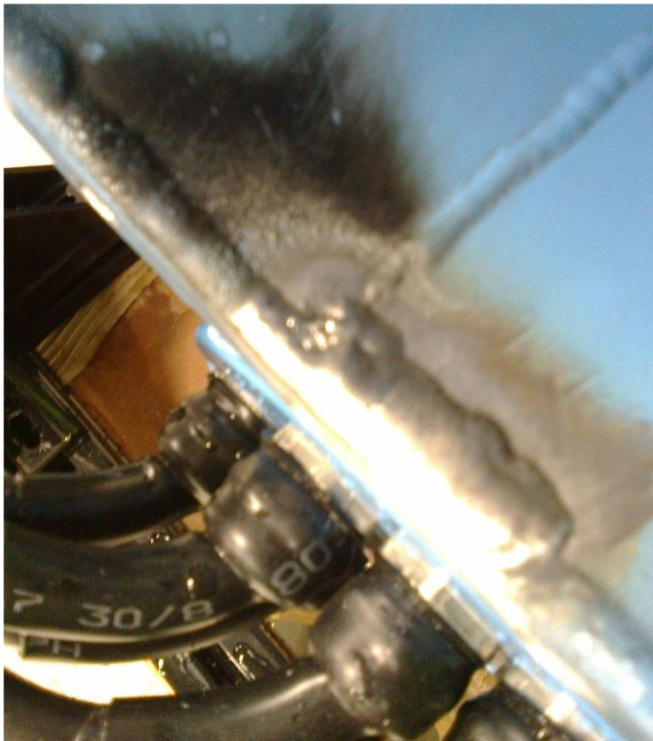
Kuva 32. Vuotokohta ylhäältä ensimmäisen korjauksen jälkeen
