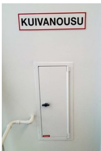
Kuva 10. Kuivanousun ulosotto esimerkiksi kerrostalon porrashuoneessa. (Päijät-Hämeen pelastuslaitos, 2022.)
