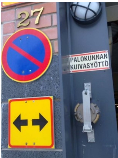
Kuva 11. Sammutusvesiputkiston lukittu syöttöliitin katutasolla. (Päijät-Hämeen pelastuslaitos, 2022.)
