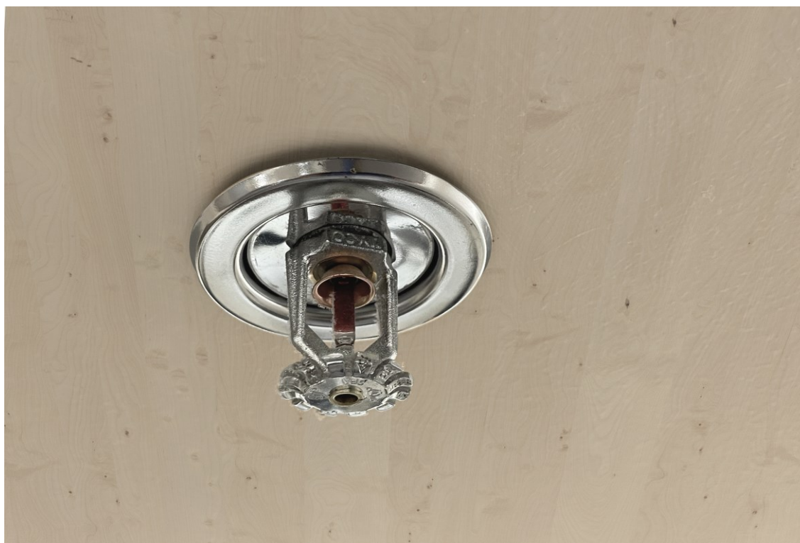
KUVA 6. Sprinkleri alakatossa (Vladimir Vahvijainen 2022)
